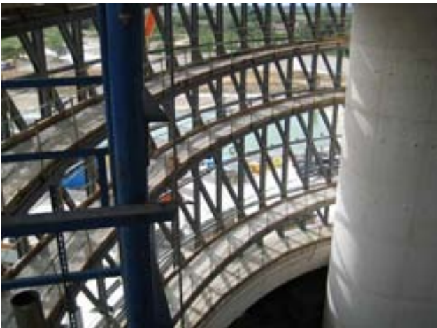
Figura 7 – Tramos inferiores de la fachada con doble longitud de pandeo a causa de la eliminación de una de las rampas
