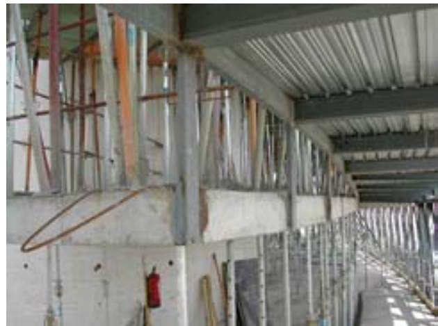
Figura 8 – Apoyo elástico de los forjados de descansillo en la fachada a través de las vigas metálicas de la rampa
