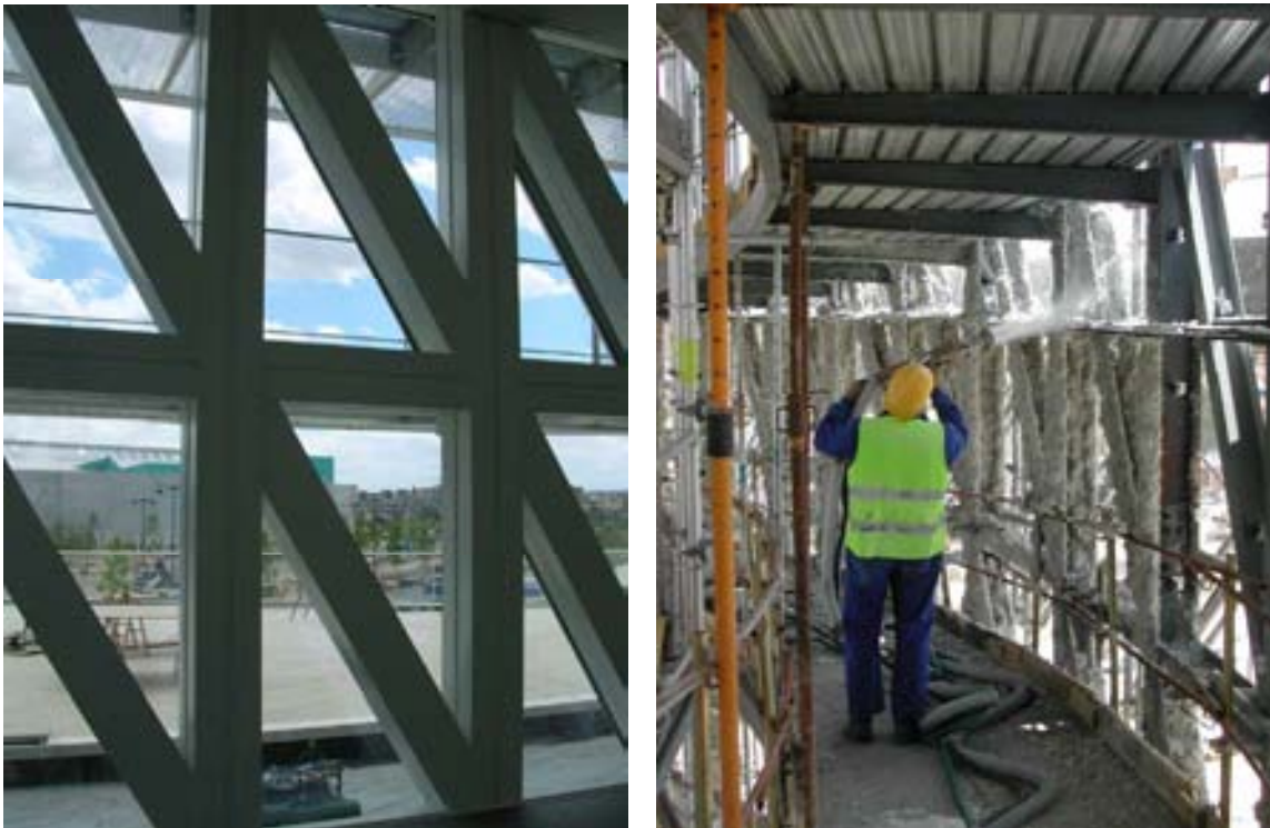
Figura 9 – Aplicación de la protección ignifuga de la fachada y vista final una vez colocado el revestimiento de aluminio
