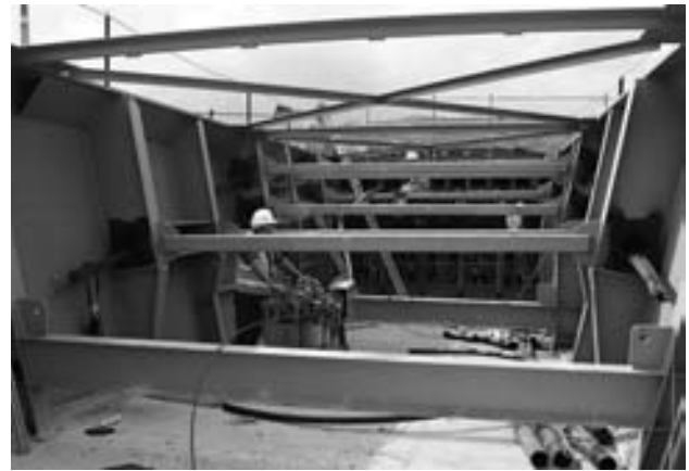
Figura 33. Vista interior de los anclajes de pretensado con los tubos de arriostramiento de rigidizadores.
