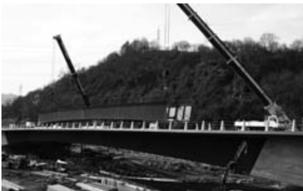
Figura 26. Transporte del tramo central del segundo viaducto sobre el primer puente ya concluido.
