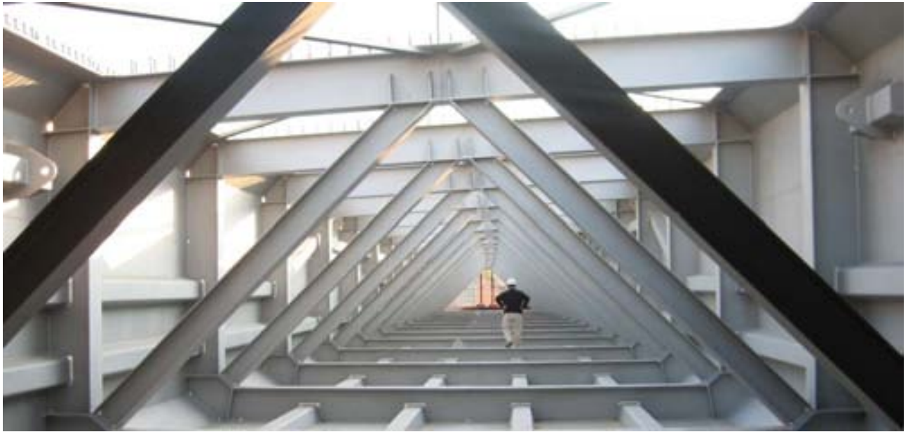
Fig. 2 Interior del cajón metálico
