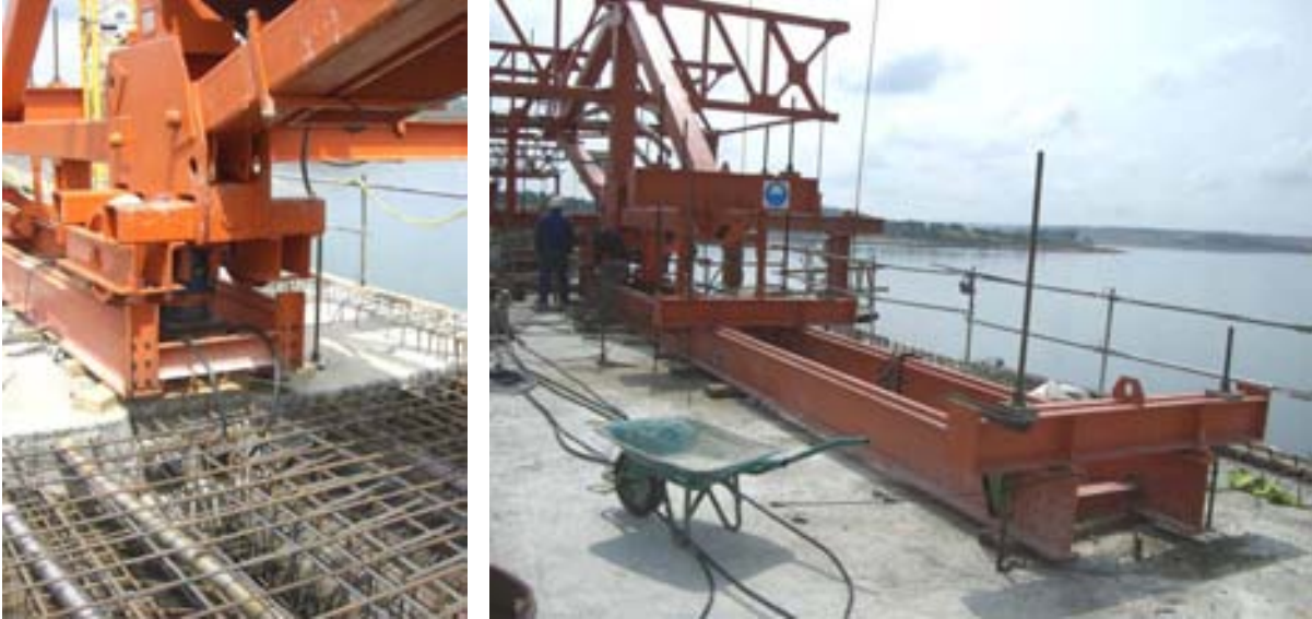
Fig.12 Apoyo del carro en el frente de la última dovela ejecutada y barras de anclaje en su parte trasera
