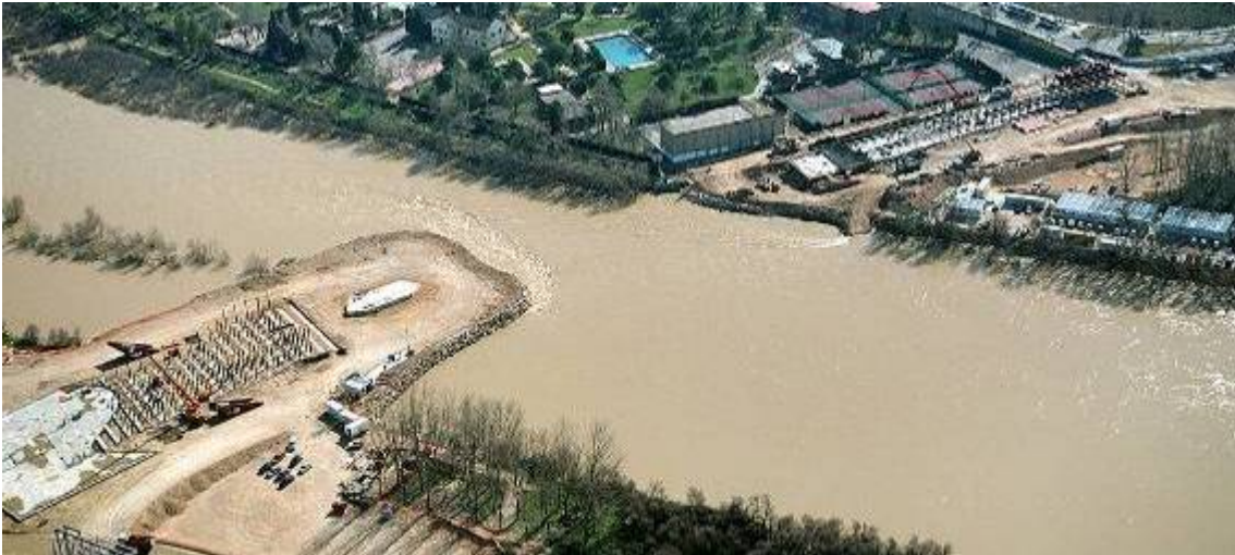
Fig.2 Febrero de 2007. Vista de la península provisional construida en la orilla norte (margen izquierda) y área de montaje del vano principal en la margen derecha.
