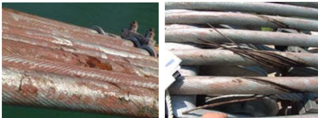
Fotos 13 y 14. Detalles de zonas con notable deterioro por corrosión de cables
