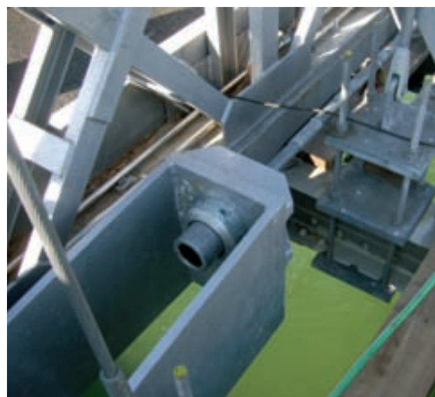
Figura 29. Nuevo cable horizontal y su terminal activo.
