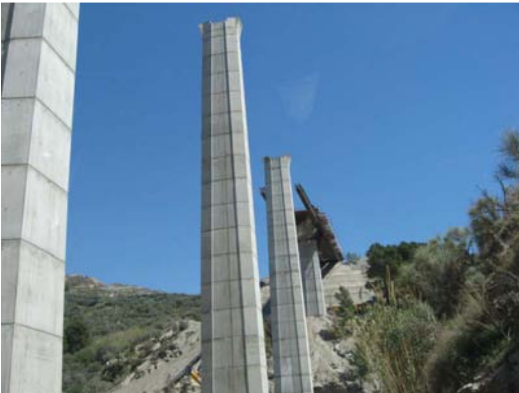
Fig. 4 Vista de las pilas 12 a 14, con la autocimbra montada entre el estribo 2 y la pila 14
