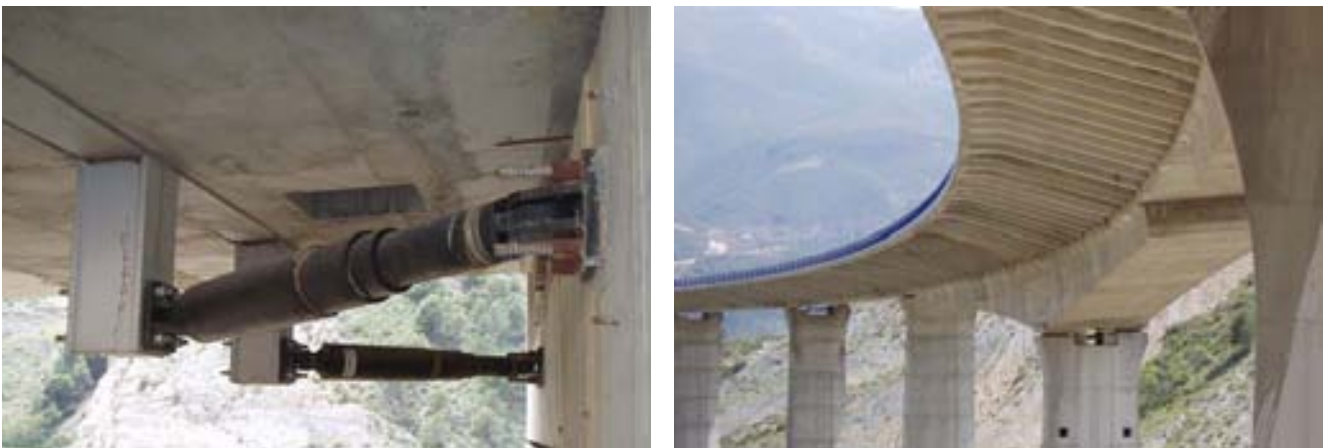
Fig. 6 Disipadores sísmicos en estribo 1 (izquierda) y en pilas 2 y 4 (derecha)
