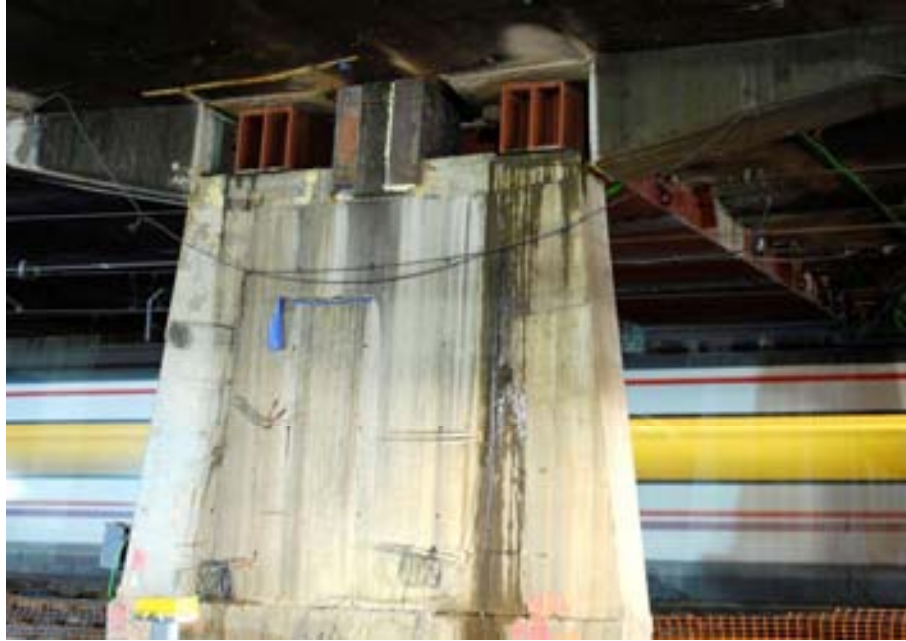
Figura 6 – Apoyo de dintel en la pila extrema reforzada
