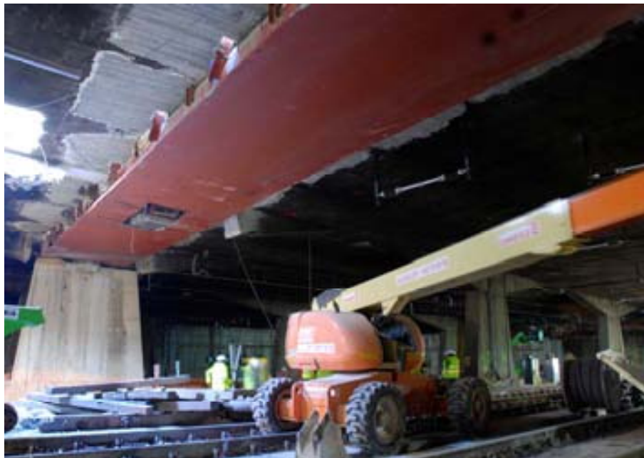
Figura 10 – Vista del cordón inferior del dintel B después de la demolición del soporte apeado
