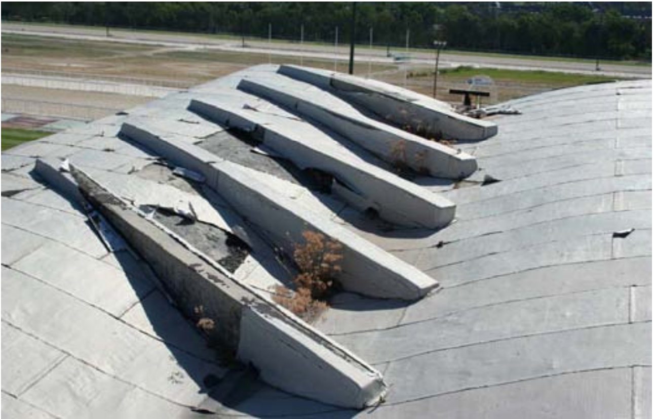
Fig. 2 Estado de la impermeabilización de las cubiertas
