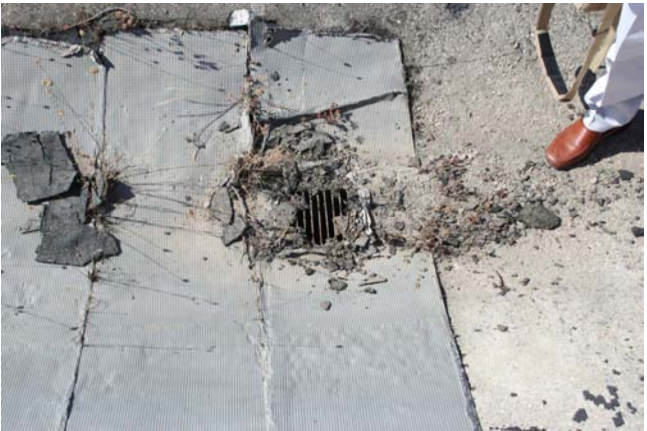
Fig. 3 Estado de los sumideros
