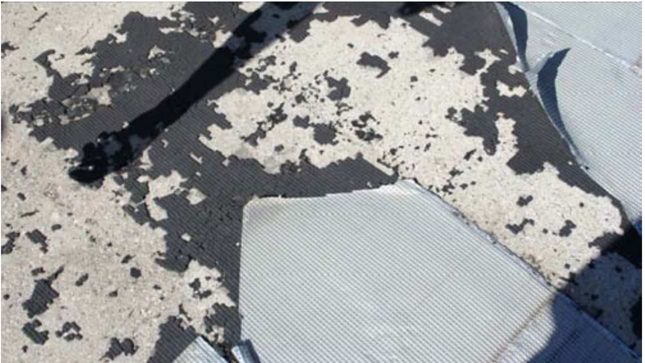
Fig. 5 Meteorización de la lámina asfáltica
