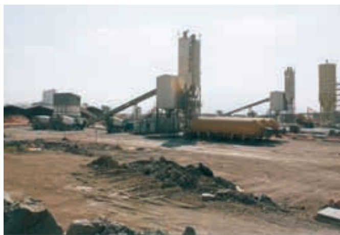
Figura 6.2.1. Plantas de hormigón.
