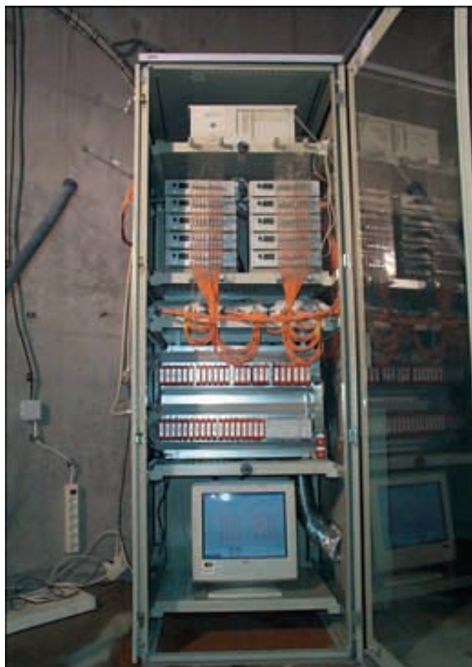
Figura 5.7.9. Armario de centralización del sistema.
