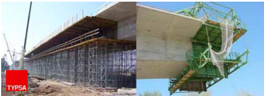
Figura 9. Viaducto sobre el Guadalquivir. Cimbrado de vanos de aproximación y detalle de carro de avance para los vanos centrales.
