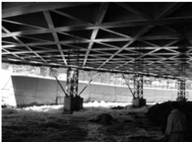
Figuras 22a y 22b. Construcción del tablero. Apoyos provisionales para el montaje.
