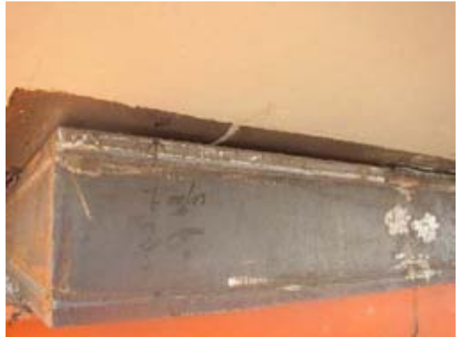
Fig 28. Despegue de torretas provisionales
