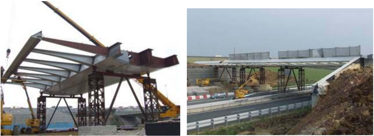
Fig. 8 Imágenes del montaje de la estructura metálica de tablero sobre apeos provisionales
