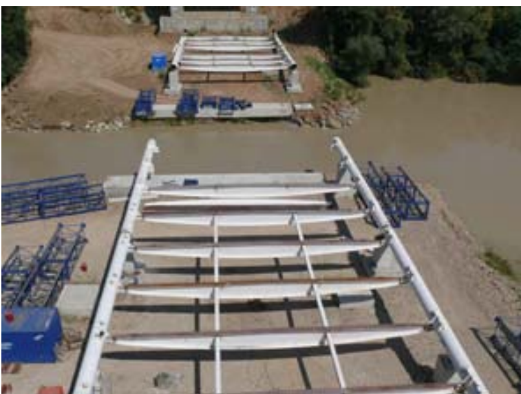
Fig. 8: Vista de las penínsulas artificiales y de las labores de ensamblaje de la estructura metálica del tablero
