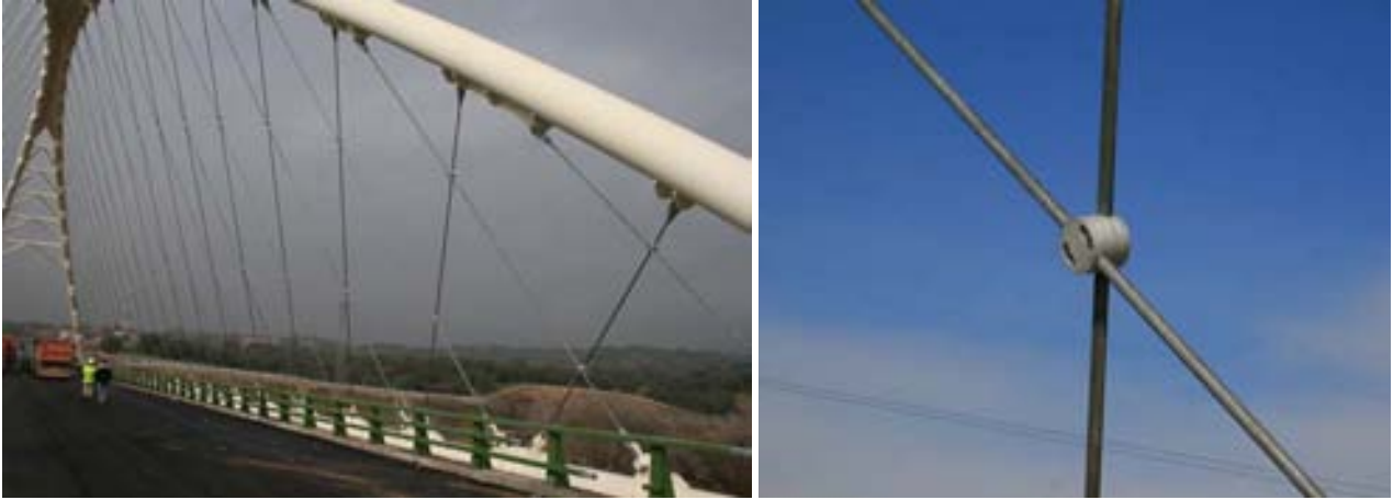
Figs. 13a y 13b: Detalle de péndolas en dos planos paralelos con los dispositivos de cruce de péndolas
