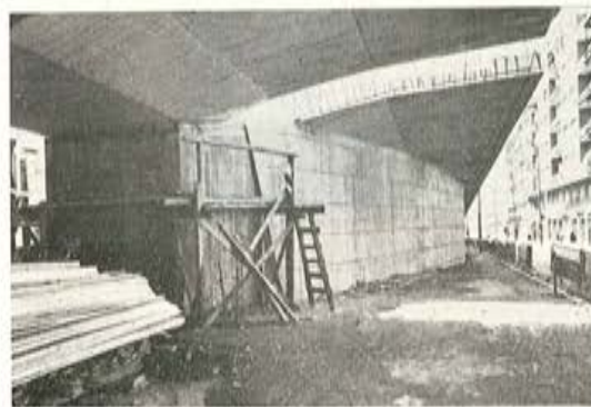
Fig. 9. — Franja de hormigonado posterior para igualar las deformaciones del voladizo transversal en el tablero y estribo.
