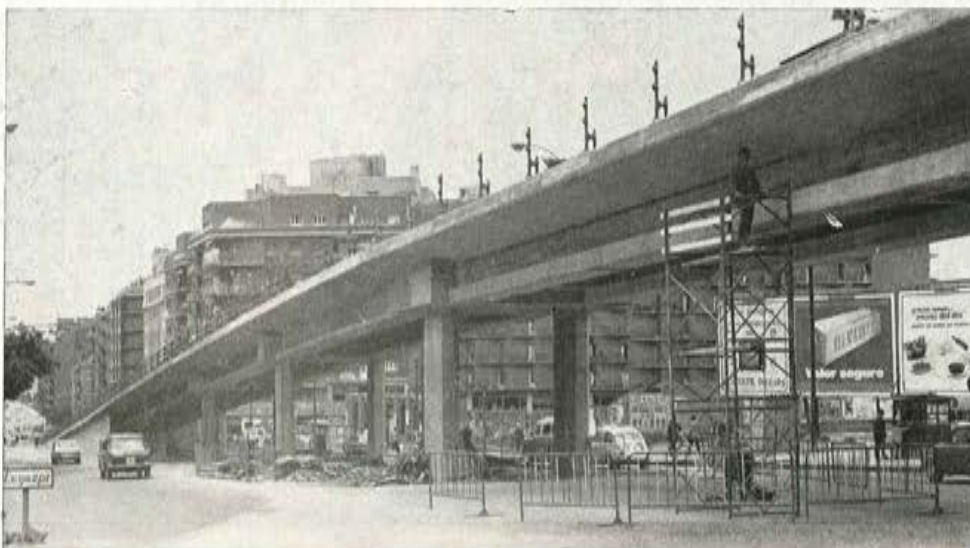
Fig. 3.—Vista de los tramos de 20 m y de dos vigas del ramal principal.
