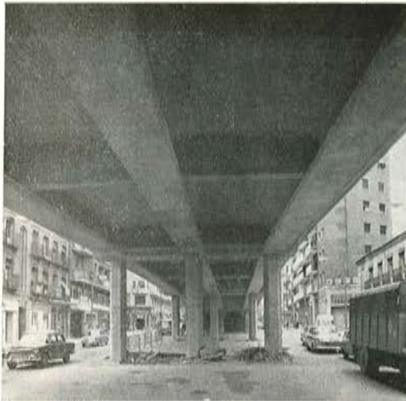
Fig. 1. — Vista inferior de los tramos de 20 m y de tres vigas del ramal principal.
