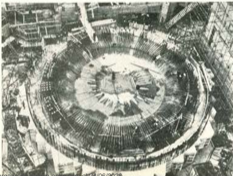
Fig. 20. — Construcción de la parte inferior del edificio de presión de Dungeness B. Obsérvense los salientes para los anclajes.
