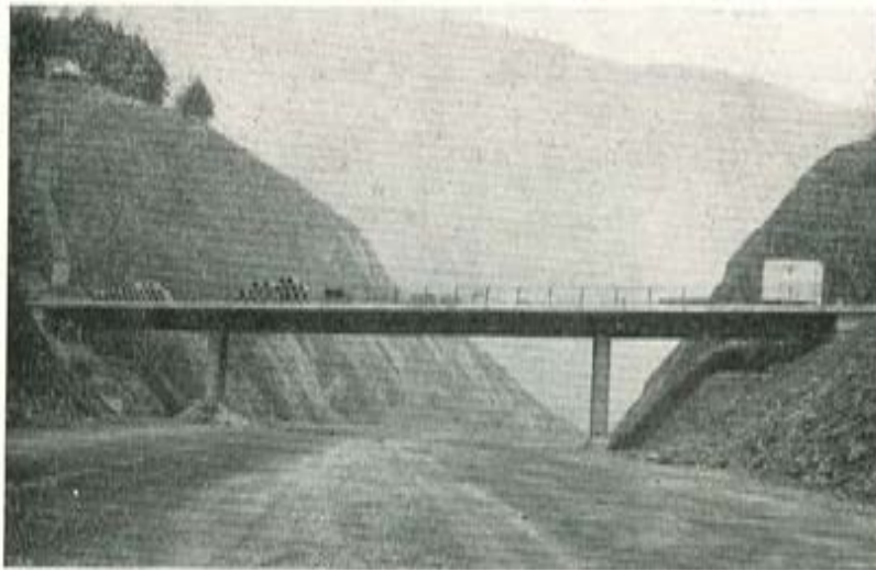
Fig. 4. — Paso superior en losa continua de canto constante (E.III-6, autopista bajo Camino Urki).
