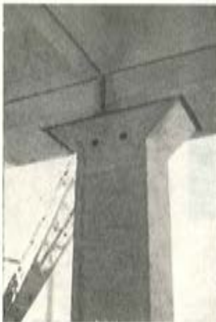
Fig. 15. — Nudo del pilar intermedio con las vigas de entreplanta y la artesa.
