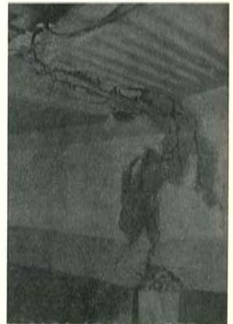
Fig. 13. — Detalle de rotura de la viga.
