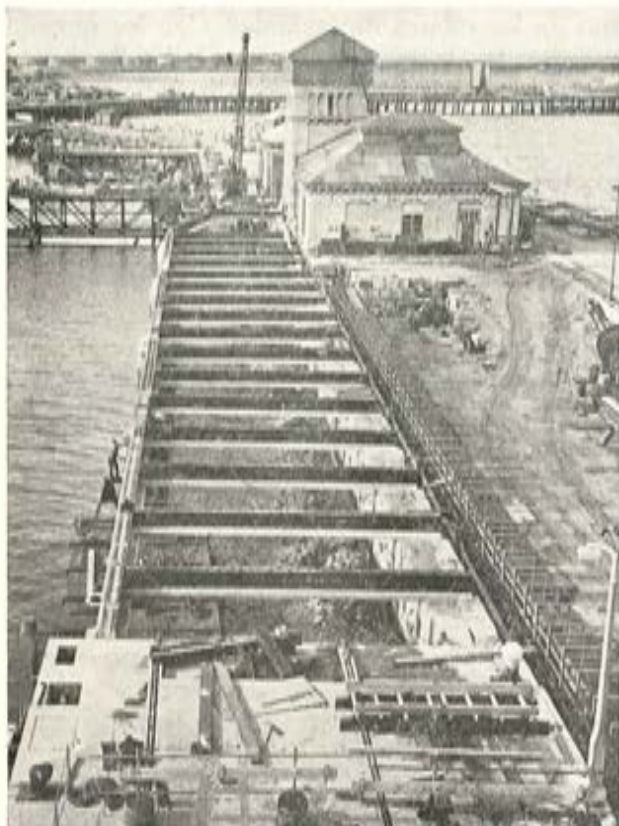
Muelle de carga construido con vigas Preflex en ambos sentidos, longitudinal y transversal.
