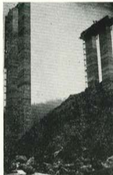
Fig. 16. — Viaducto de Istiña. Pila 2 terminada, formada por dos fustes rectangulares de 6 \times 3 m y 72 m de altura.
