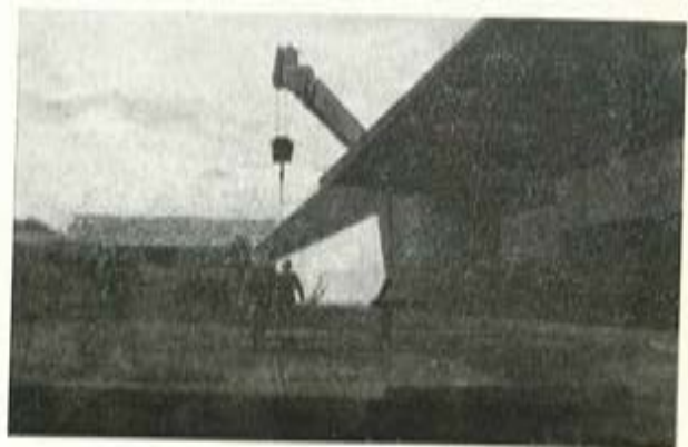
Fig. 2.— Una perspectiva de la viga con la grúa al fondo, cogiéndola ya para ponerla en el Dolly.
