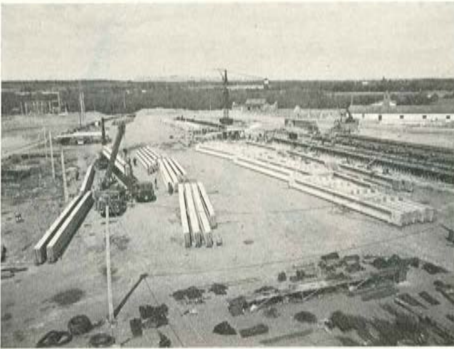
Vista de conjunto de la instalación.
