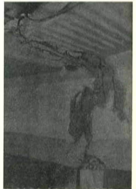
Fig. 13. — Detalle de rotura de la viga.
