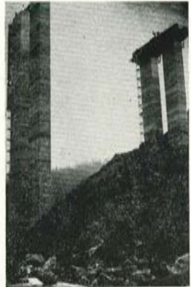
Fig. 16. — Viaducto de Istiña. Pila 2 terminada, formada por dos fustes rectangulares de 6 \times 3 m y 72 m de altura.
