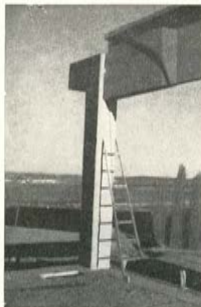
Fig. 12.—Una visita de cómo queda listo para hormigonar con mortero en su parte superior con una cuña, que lo que hace es mantenerlo vertical. En esa ranura se colocaba luego una tira de moltopreno que servía de junta estanca.
