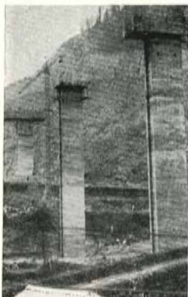
Fig. 14. — Pilas formadas por fuste único rectangular hueco y dintel en ménsula (A-114, viaducto Subiberri autopista sobre CN-634, F.C. y río Deva).
