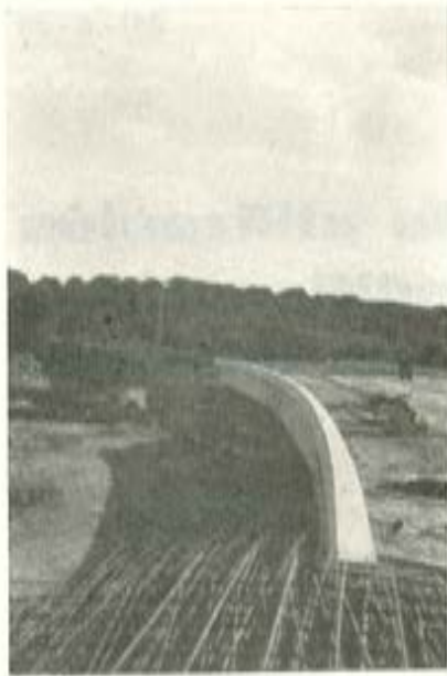
Fig. 3. — Vista del puente por su lado cóncavo. Se puede apreciar la curva de la cabeza superior y la línea recta de la arista de la fibra inferior.
