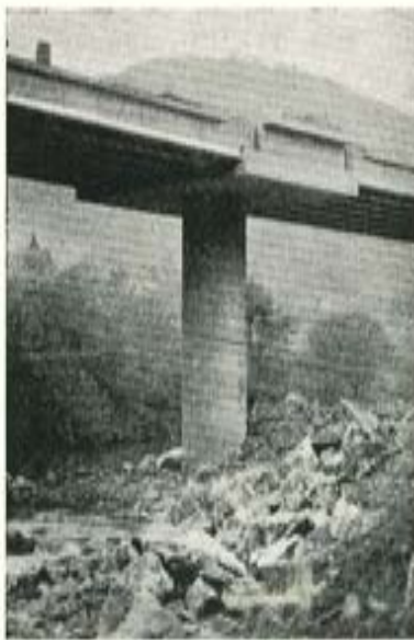
Fig. 12. — Dinteles en ménsula sobre fustes de \phi 3 m para adaptarse a distintas luces (A-112, autopista sobre CN-634, río Deva y FC, Bilbao-San Sebastián).
