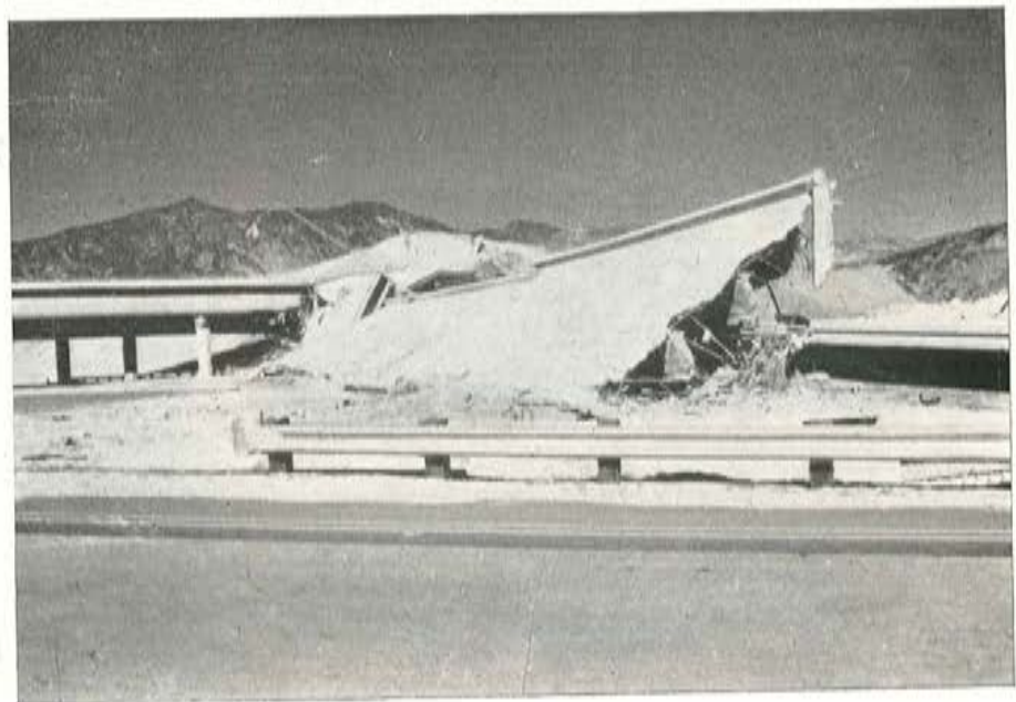
Fig. 11. — Algunos aspectos de puente de autopista después del terremoto. Para reparar muchos de los daños causados se utilizaron las resinas del PREH.
