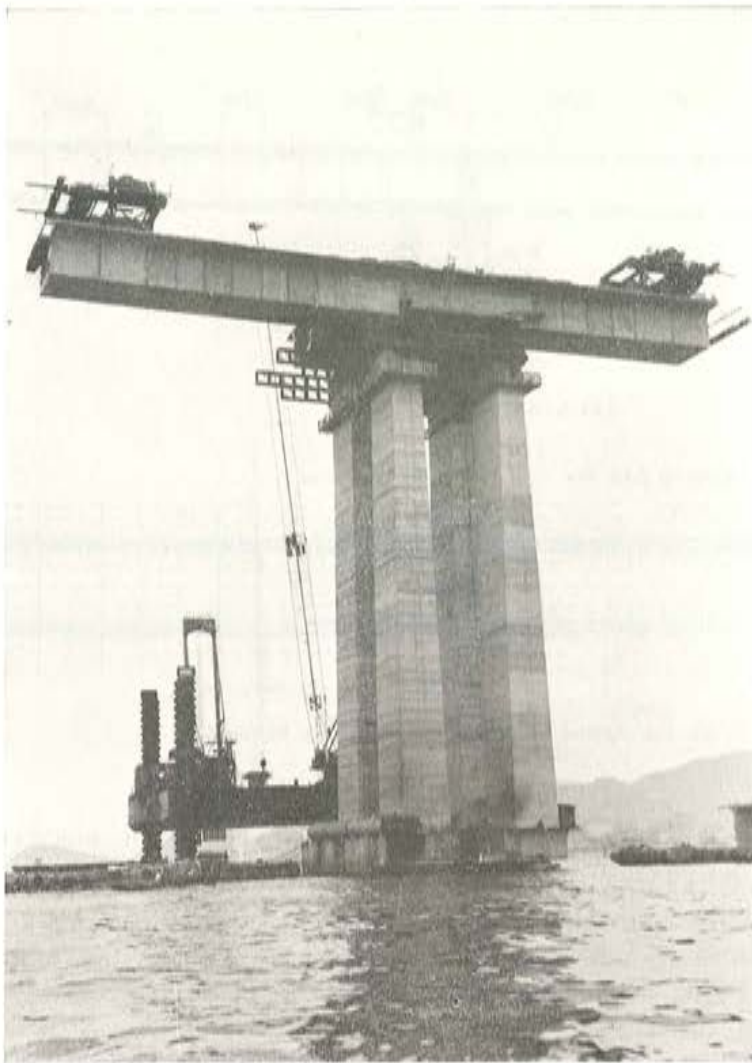
Fig. 17. — Montaje de las dovelas mediante dos pequeñas vigas auxiliares metálicas sobre la pila P98.
