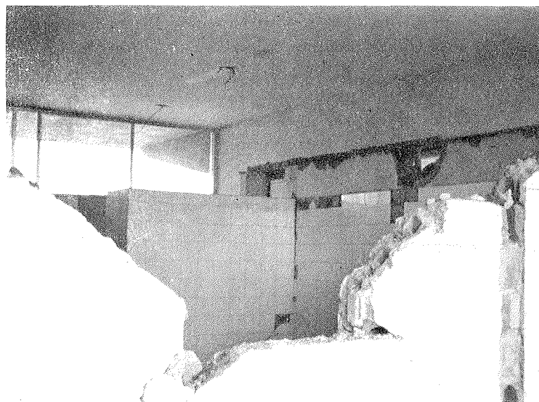
Foto 4. — Elementos no estructurales unidos a los marcos del edificio, que no fueron capaces de tolerar las deformaciones de éstos. Chimbote (Perú), sismo 1970.
