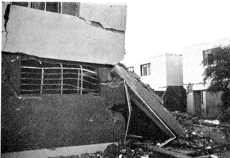
Foto 7.— Viviendas de albañilería sin elementos dúctiles (columnas o vigas de amarre). Chimbote (Perú), sismo 1970.
