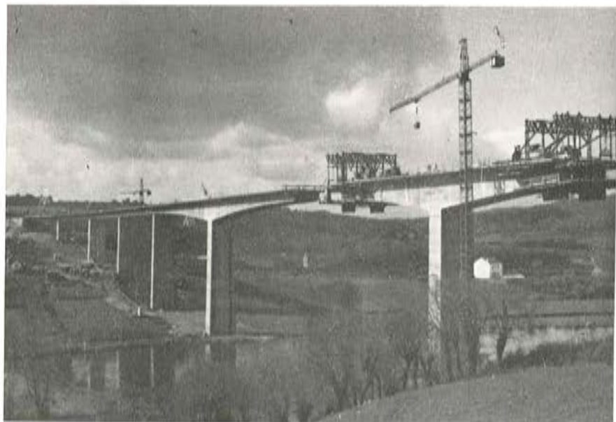
Puente sobre el río Miño, en Lugo. Luces: 36 + 3 \times 45 + 54 + + 108 + 54 + 45 + 36 m. Construye: Entrecanales y Tá- vora, S. A.
