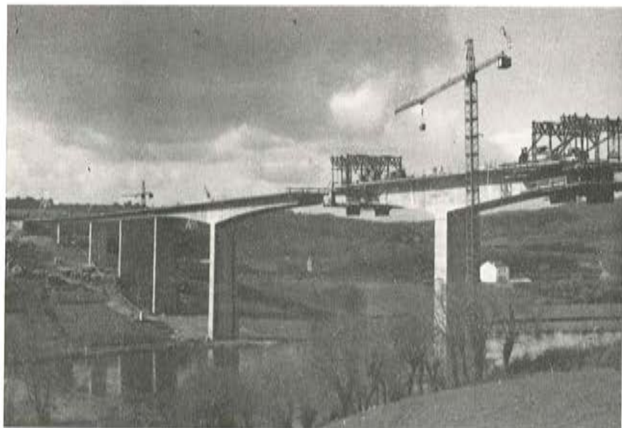
Puente sobre el río Miño, en Lugo. Luces: 36 + 3 \times 45 + 54 + + 108 + 54 + 45 + 36 m. Construye: Entrecanales y Tá- vora, S. A.
