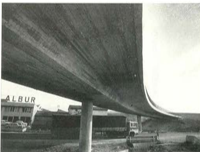
Fig. 37. Paso sobre la carretera de Zaragoza. Detalle del apoyo puntual. (Variante Oeste de Pamplona).
