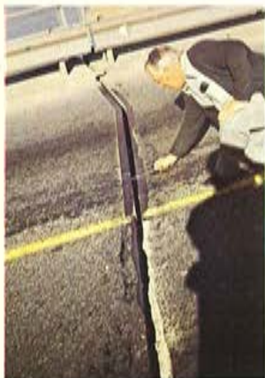
La junta antes de ser reparada.
