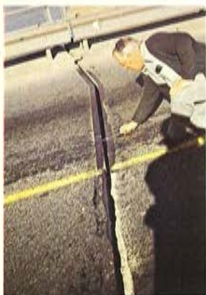
La junta antes de ser reparada.
