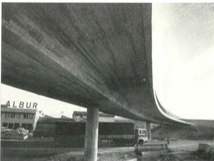
Fig. 37. Paso sobre la carretera de Zaragoza. Detalle del apoyo puntual. (Variante Oeste de Pamplona).
