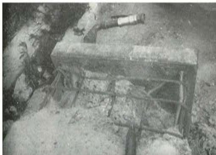
Foto 35. Detalles del resultado de los ensayos de estanqueidad a la grasa.
