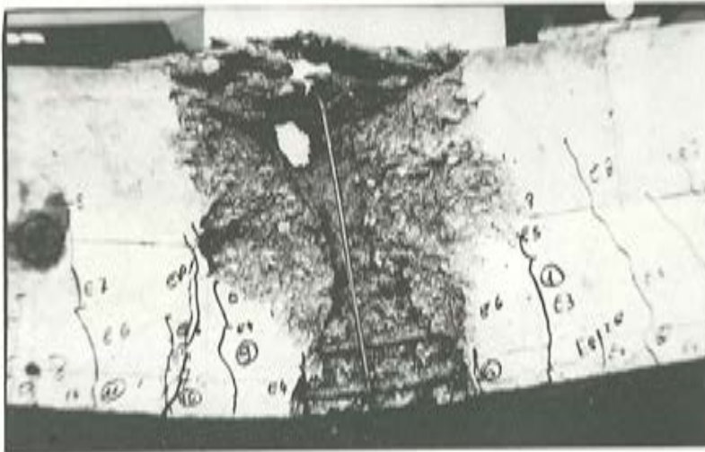
FOT. 6.-V2-OA. Rotura
