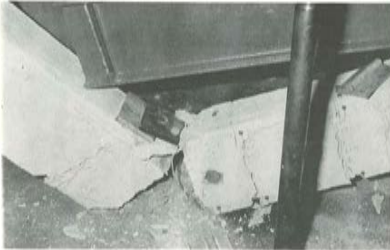
FOT. 14.—V1-NB. Rotura
