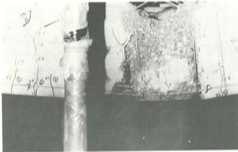
FOT. 12.-V2-OM. Rotura
