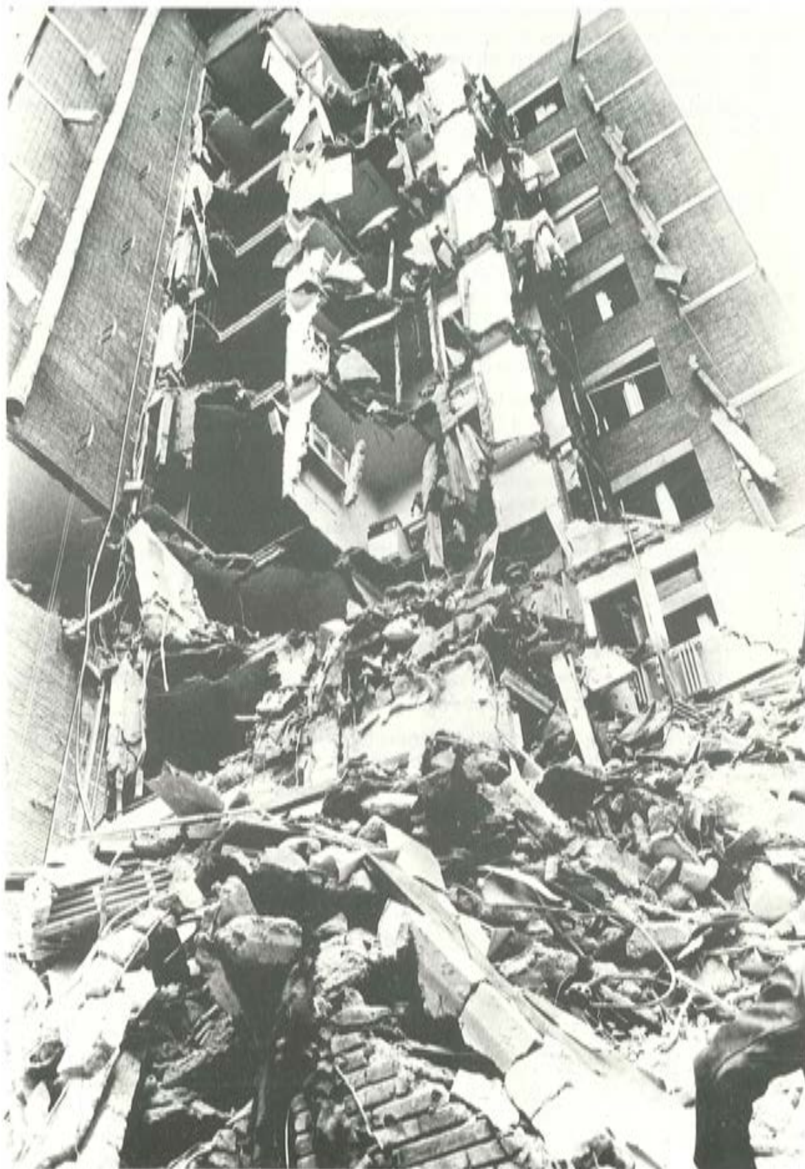
Fotografía núm. 1.—Colapso de esquina, edificio calle Capitán Arenas en Barcelona (marzo, 1972). Fotografía de archivo del diario "La Vanguardia" cedida al I.E.T. para su publicación en Hormigón y Acero.
