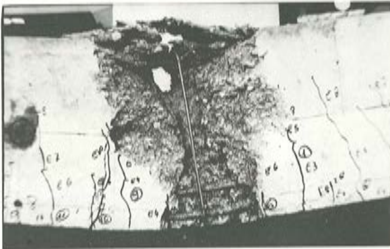
FOT. 6.-V2-OA. Rotura
