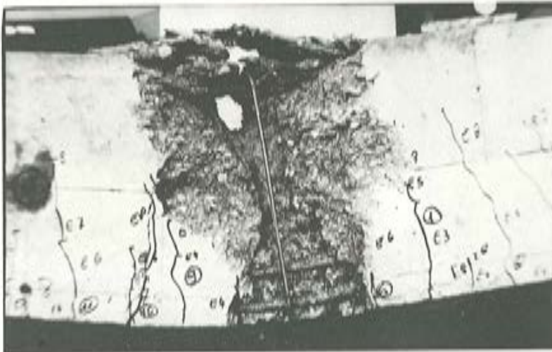
FOT. 6.-V2-OA. Rotura
