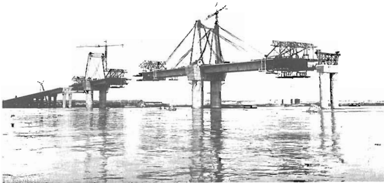
Fig. 3.13 Puente sobre el río Magdalena en Barranquilla, Colombia. Otro aspecto de la construcción.
