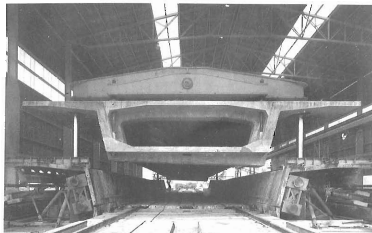
Fig. 3.14 Puente de San Severino en la autopista Caserta-Nola-Salerno. Tramo prefabricado dispuesto para colocarlo sobre los carretes de transporte.
