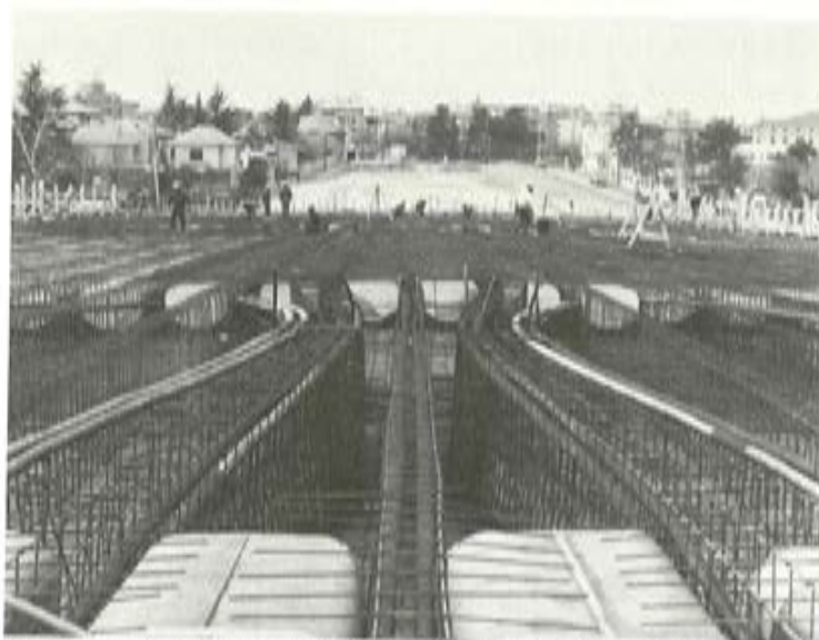
Fig. 7. - Paso superior del Sagrado Corazón, Detalle de aligeramientos y ferralla.
