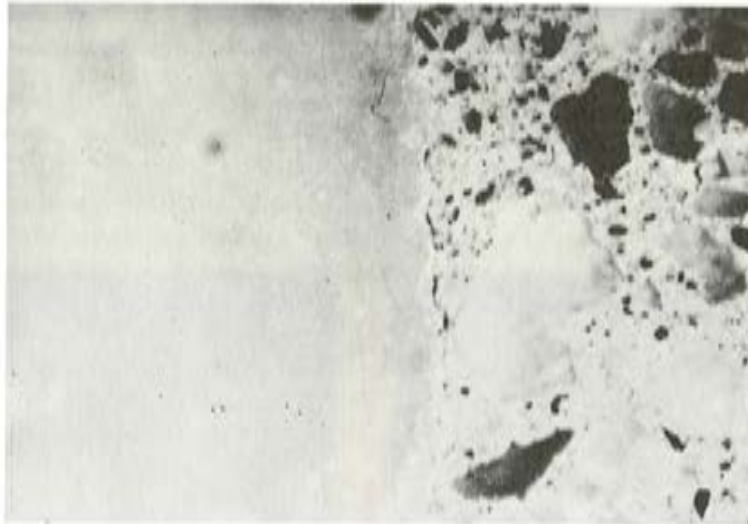
Fig. 1. Fisuras del mortero.
