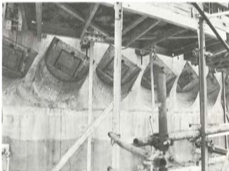
Fot. 52.— Parte central de la viga anillo desencofrada. Pueden apreciarse bien los cajetines de los anclajes de la cúpula.
