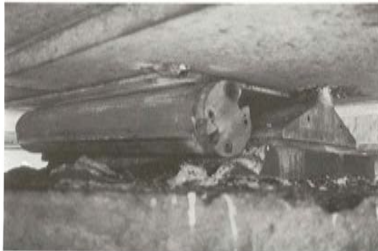
Fig. 3. Rodillos desplazados fuera de su placa de rodamiento debido a producirse simultáneamente una dilatación máxima y asentamiento del terreno. Se hubiese podido evitar si se hubiese aplicado el Coeficiente de Seguridad Geométrico en las dimensiones de la placa de rodamiento.
