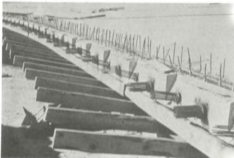
Fig. 22. Puesto I. Vista de anclajes del pretensado transversal en vanos extremos. Los horizontales corresponden a tendones del forjado superior, los más inclinados pertenecen a los tendones del pretensado del contorno inferior de la sección. (Tabiques inclinados y fondo).
