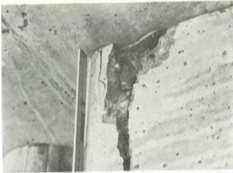
Fig. 7. Grieta producida en el borde de un estribo al emplear apoyos de espesor demasiado pequeño, por lo que entraron en contacto directamente elementos de la estructura sin que el apoyo llegase a funcionar.
