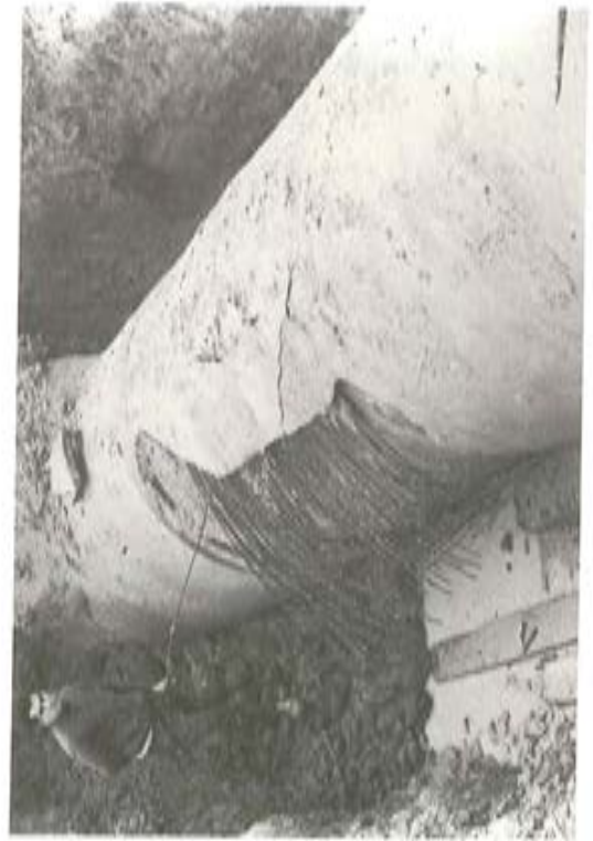
Fig. 4. Rotura de tuberías pretensadas.
