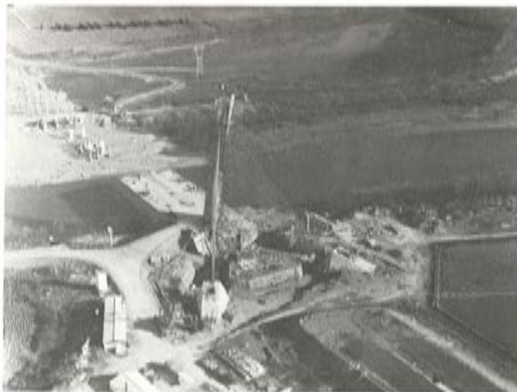
Fig. 4.— Vista aérea general durante construcción. Puede verse la disposición de los contrapesos y las vigas de enlace.
