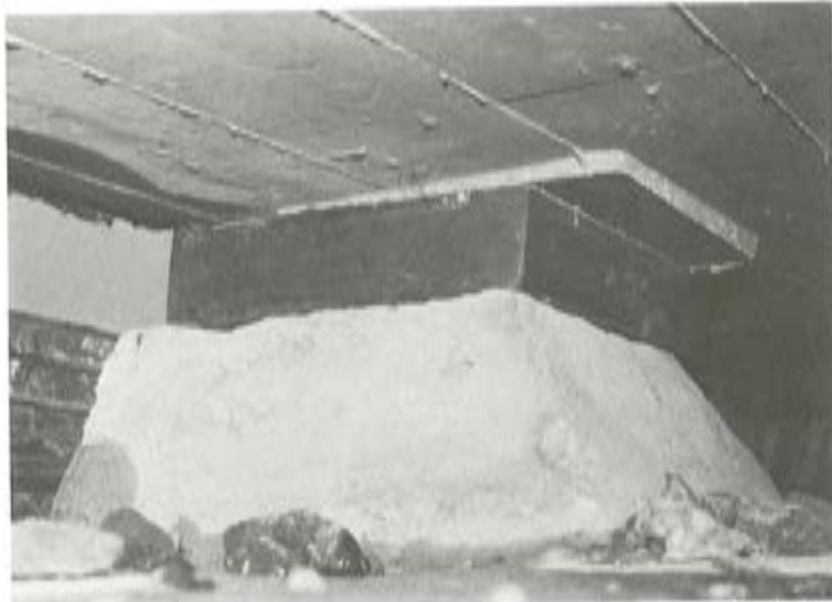
Fig. 1. El tablero ha deslizado sobre el apoyo al estar recubierto de aceite deslucifante.
