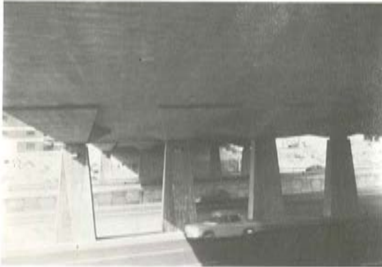
Fig. 12.— Paso superior de Ramón y Cajal. Vista inferior de la obra terminada.
