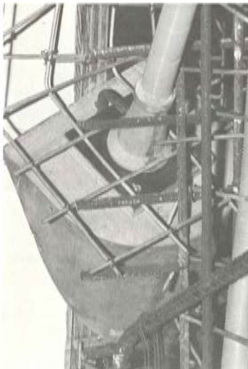
Fot. 14.— Detalle del trasdós de un cajetín y su refuerzo.
