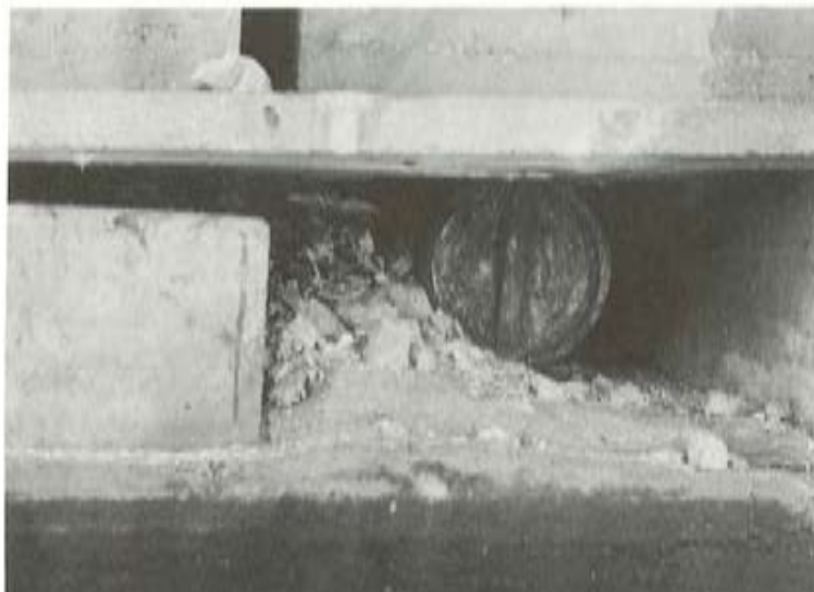
Fig. 9. Apoyo de rodillo inutilizado por la suciedad que ha dejado pasar una junta de dilatación permeable.
