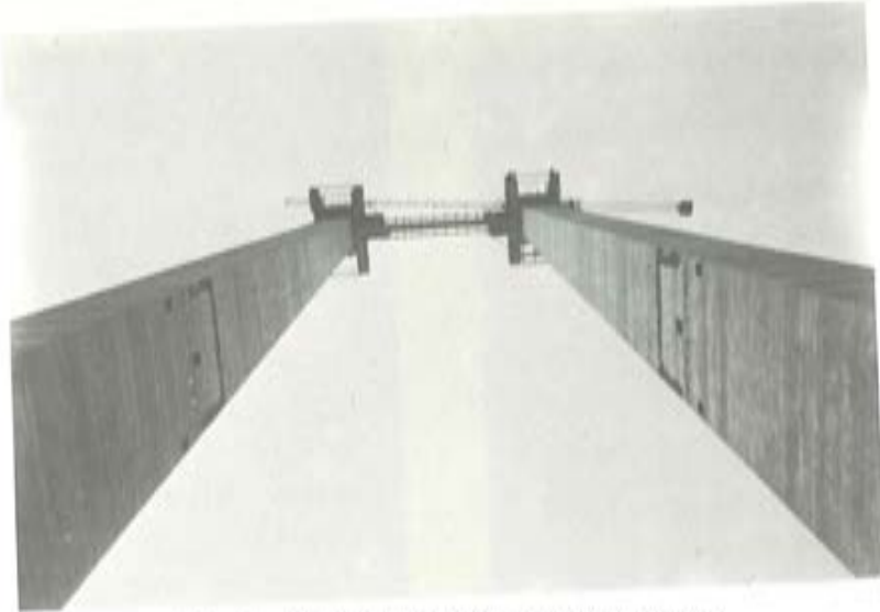
Fig. c).— Deslizamiento de las pilas principales.
