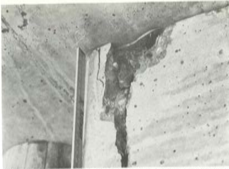
Fig. 7. Grieta producida en el borde de un estribo al emplear apoyos de espesor demasiado pequeño, por lo que entraron en contacto directamente elementos de la estructura sin que el apoyo llegase a funcionar.
