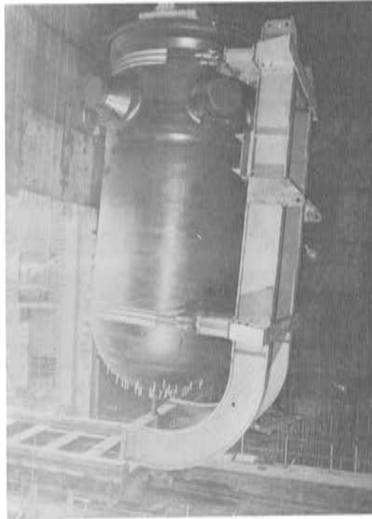
Fot. 31. Izado del reactor nuclear, por la grua polar, para ser colocado, en su ubicación final.
