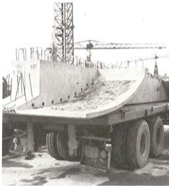
Figura 32. — Transporte de uno de los conjuntos, lámina de encofrado-viga, prefabricados por la empresa E.P.I., y utilizados en la construcción del viaducto central.
