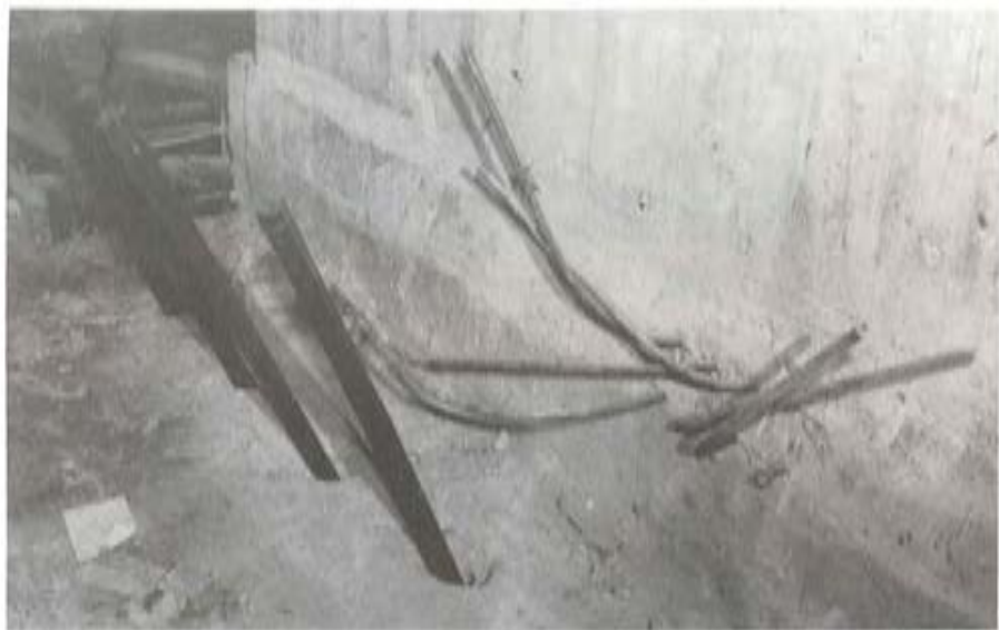
FOTO 3. —Cuatro mazos de alambres de \phi 7, una vez enfilados y antes de colocar los anclajes activos.
