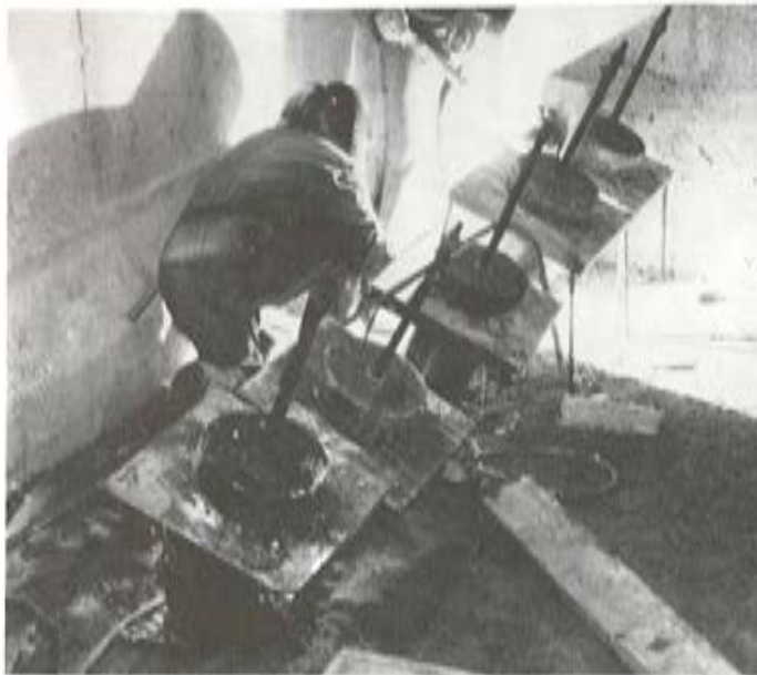
FOTO 4. —Colocación de cinco anclajes activos de 250 tn, en la cara superior de un encepado.
