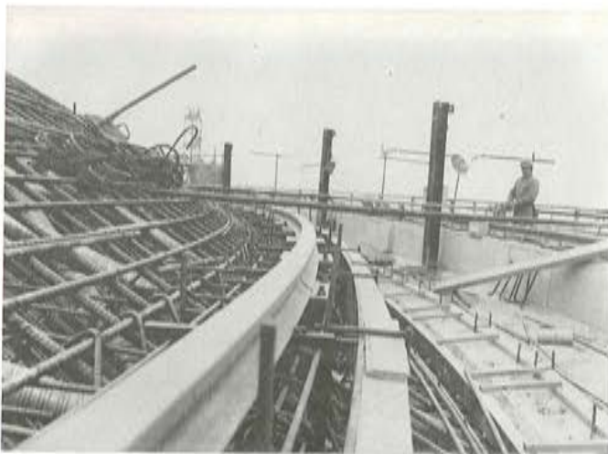
Fotografía 23: Cúpula Ed. Contención—Detalle colocación del riel para la soldadura de póticos móviles.
