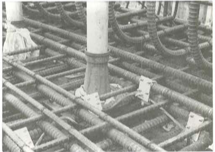
Fotografía 5: Detalle de la fotografía anterior – Trmpetas de los tendones y puesta a tierra de las armaduras.
