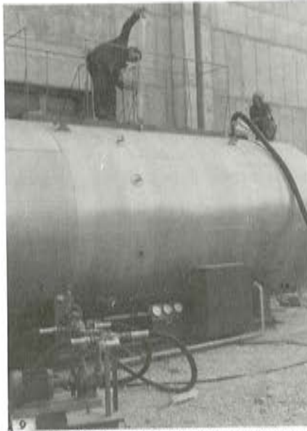
Fotografía 11. Llenado de grasa de uno de los 2 depósitos de grasas.
