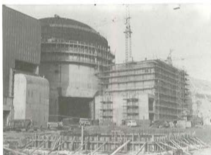
Fotografía 16: Entradas Equipos del Edificio de Contención.
