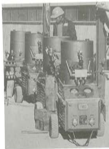
Fotografía 10. Las 4 bombas P.S. de Tesado.
