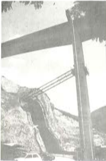
Foto 6. Viaducto de las Lamas. Apuntalamiento provisional de una pila durante la construcción.
