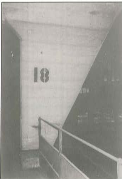
Fotografía 3. Pilar de sección variable y alzado triangular. Se puede apreciar la colocación de una red para impedir que los fragmentos del recubrimiento del hormigón que se desprenden puedan dañar a las personas que transitan por su interior.
