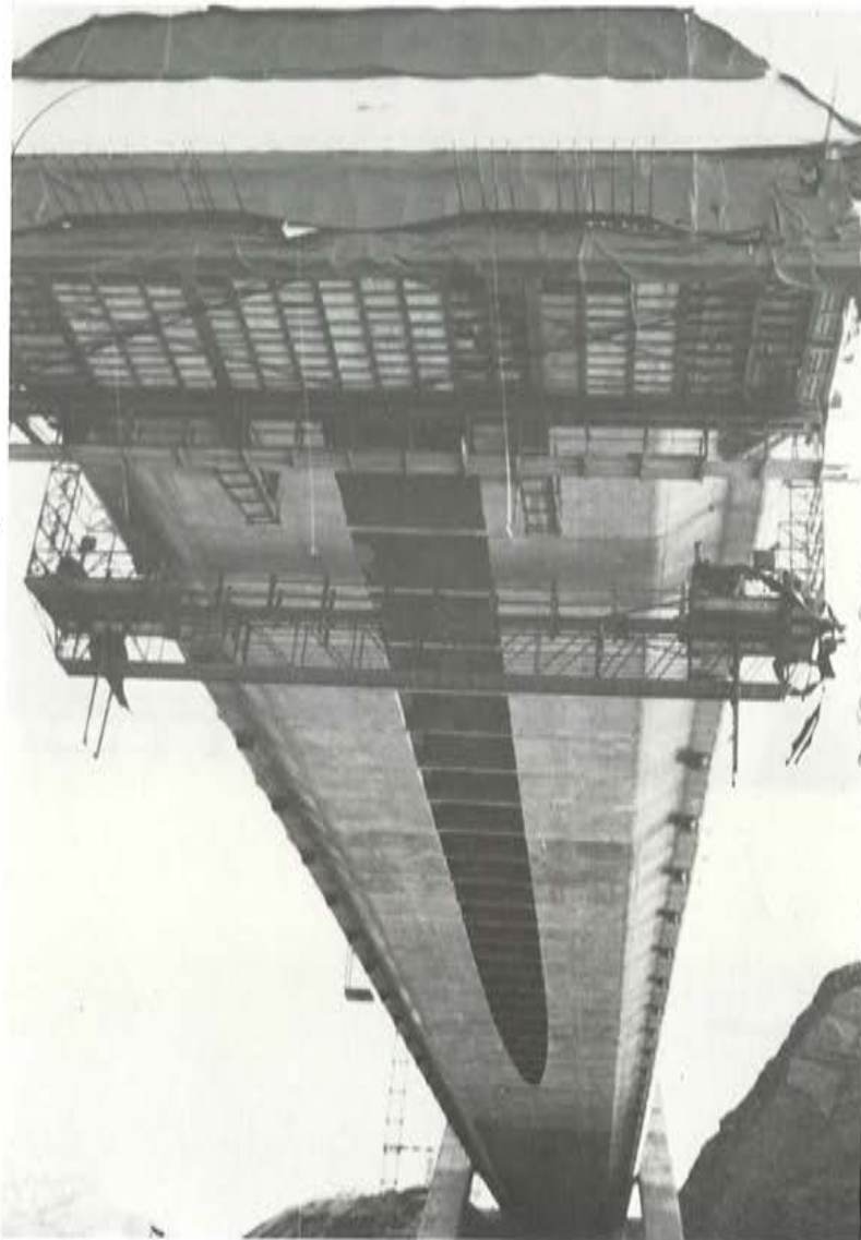
Fig. 2.22. Vista inferior del tablero durante la construcción en avance en voladizo. Junto al carro principal cerrado, se ve un pequeño carro de acompañamiento, donde se alojaban los gatos de puesta en carga total de los tirantes y servía para repasar el tablero en su parte inferior.
