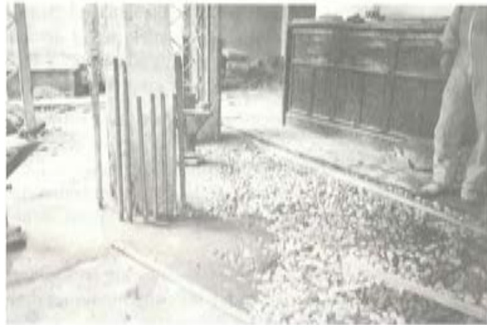
Foto 11. En la presente fotografía se aprecia una vista superior de un nudo con la armadura de continuidad sobresaliendo adosada al pilar superior que posteriormente también se reforzará. Además se puede observar el mortero de la inyección aflorando en la superficie de la grava.
