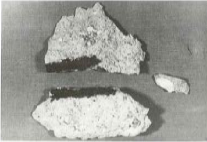
Foto 1. En esta fotografía se aprecia un fragmento del hormigón de un pilar, que se desprendió fácilmente con las manos. En la fotografía se pueden ver los restos de la armadura transformados en herrumbre y un fragmento de una concha marina.
