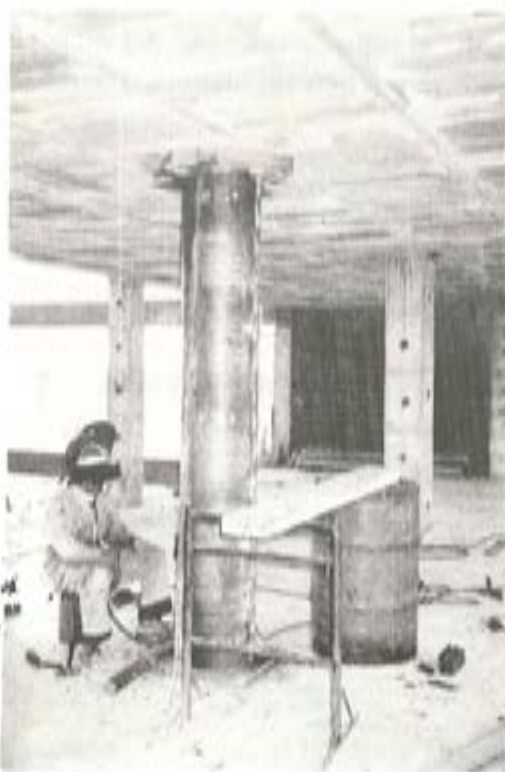
Foto 8. En esta fotografía se puede apreciar un pilar reforzado mediante un zunchado cilíndrico en una estructura normal de edificación constituida a base de forjados bidireccionales.
