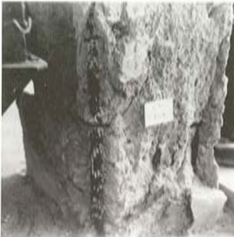
Foto 2. En esta fotografía se aprecia el estado de degradación tan avanzado en que se encontraba el hormigón de un pilar, juntamente con la corrosión total de las armaduras.
