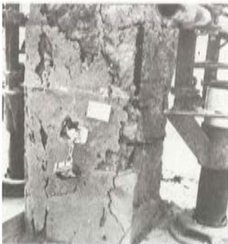
Foto 4. En esta fotografía, además de una fuerte degradación del hormigón junto con una corrosión muy avanzada de las armaduras, se puede observar un enfoscado superficial del pilar sin fines estructurales.
