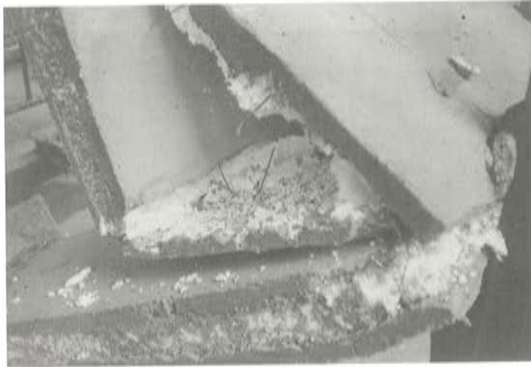
Fig. 18. Detalle de la rotura del panel C-2.
