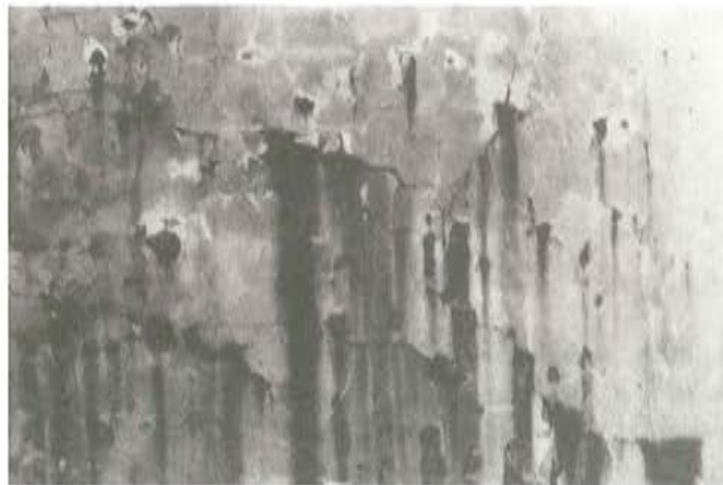
Foto 2. Una zona de los silos con el típico mapa de grietas y las manchas de óxido, que era el aspecto que presentaban antes de repararlos.
