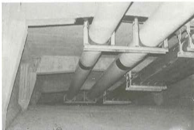
Fig. 19. Vista del interior del tablero con servicios.
