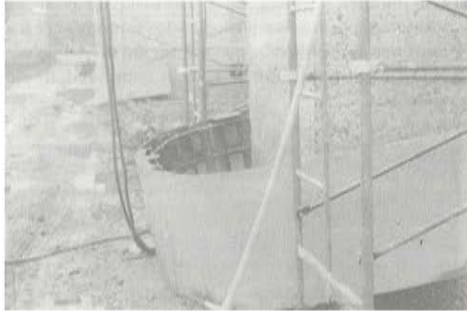
Foto 7. Exterior de una semivirola de refuerzo de una de las pilas del tramo de acceso.
