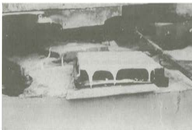
Foto 12. Sustitución de apoyos consistente en introducir el nuevo apoyo de neopreno zunchado a modo de sandwich en el apoyo existente y pegarlo mediante resina epoxi.
