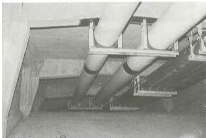
Fig. 19. Vista del interior del tablero con servicios.
