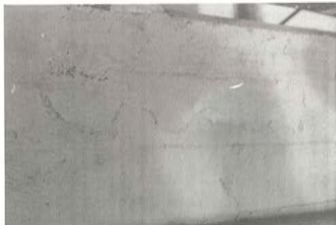
Foto 5. Paramentos del tablero que reproducen exteriormente el trazado de las armaduras según un mapa típico de fisuras debido a las tensiones creadas por la expansión de la armadura al transformarse en herrumbre.
