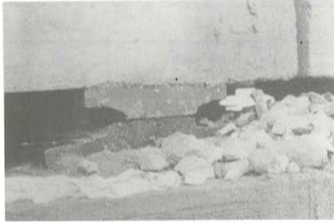
Foto 4. Uno de los apoyos metálicos del tablero, junto con los clásicos montones de balasto existentes en el plano superior de las pilas, como se comentó al describir la fotografía número 1.
