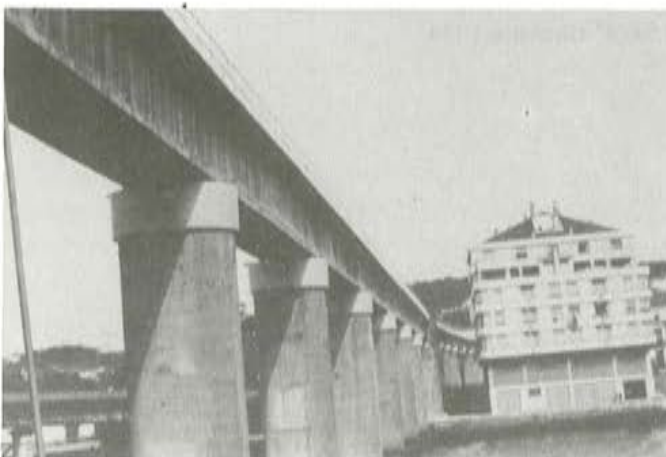
Foto 21. Perspectiva del tramo principal sobre la ría, una vez finalizada la reparación.
