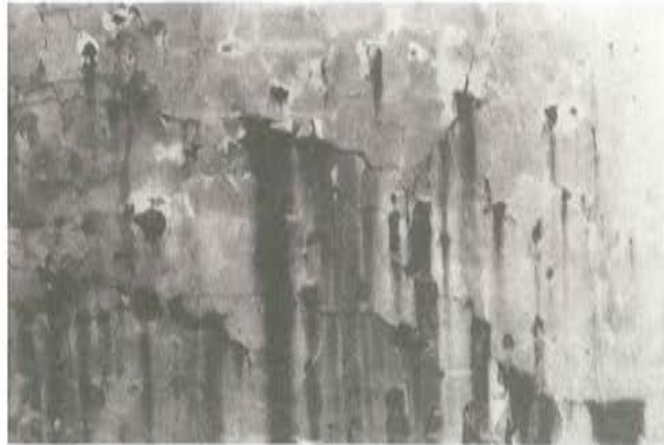
Foto 2. Una zona de los silos con el típico mapa de grietas y las manchas de óxido, que era el aspecto que presentaban antes de repararlos.
