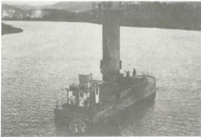
Foto 19. Transporte e izado de una de las virolas en una pila sobre la ría.
