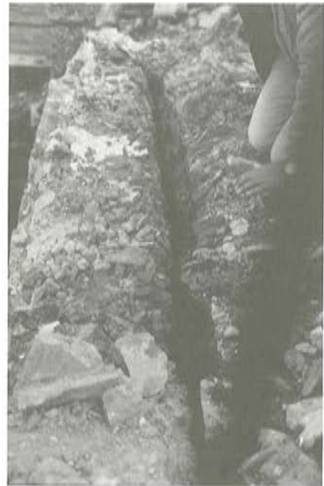
Fig. 12. Detalle de grietas existentes en las viejas bóvedas.
