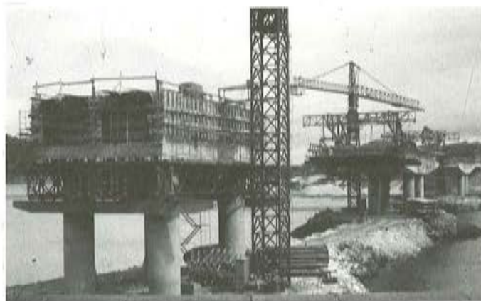
Fig. 18. Vista de las tres fases del tablero: "In situ", voladizo y vigas prefabricadas.
