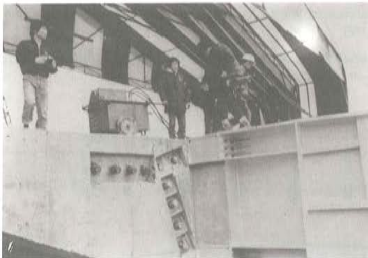
Fig. 2. KEUM GOK CHUN BRIDGE Detalle unión nariz con losa y parque de prefabricación.
