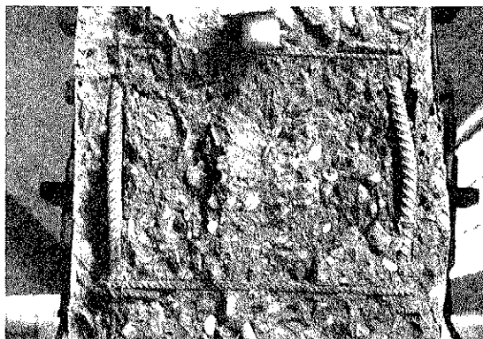
Foto 4. Detalle de la rotura de un pilar.
