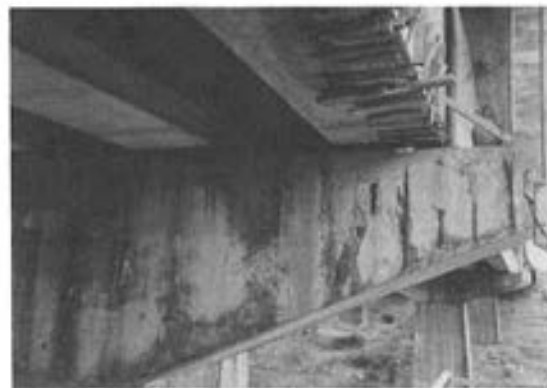
FOTO 1. Detalle de un dintel de pila con armaduras corroídas.
