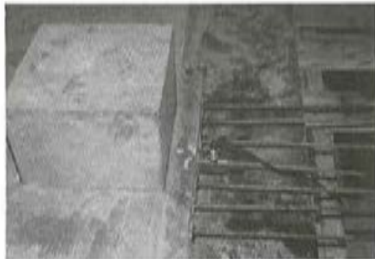
Fig. 13. Célula de carga en extremo de un tendón para medida de la fuerza en anclajes durante los ensayos.
