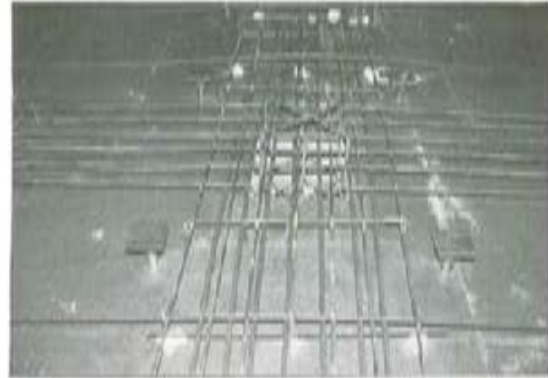
Fig. 9. Armadura activa y pasiva sobre soporte central. Observese la escasez de armadura pasiva y la ligera curvatura de los tendones.
