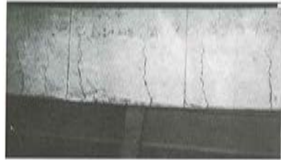
Foto 22. Viga 6 (escalón de rotura nominal).
