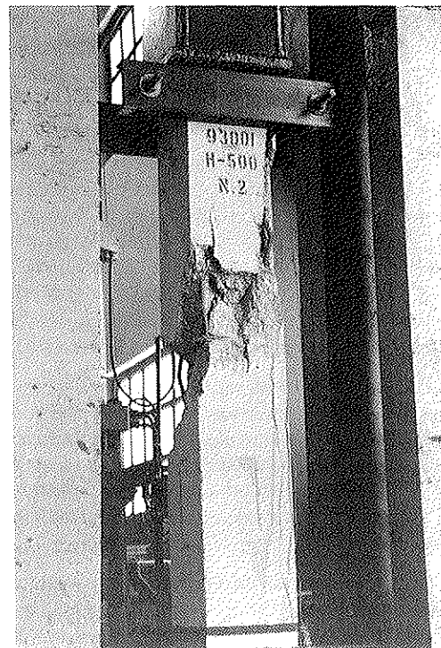
Foto 8. Rotura de un pilar de hormigón H-500.
