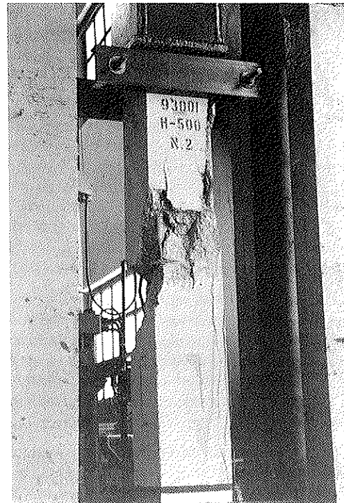
Foto 8. Rotura de un pilar de hormigón H-500.
