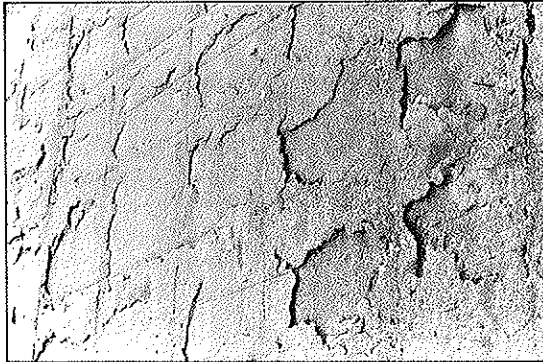
Fig. 2. Daño presentado, donde se aprecia el efecto expansivo de los óxidos.
