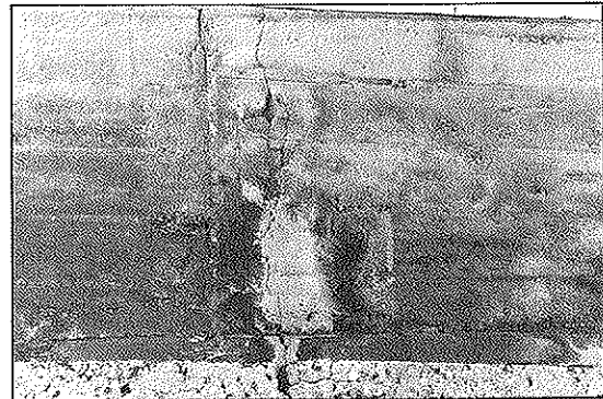
Fig. 4. Aspecto de una de las fisuras verticales del antepecho de la terraza.
