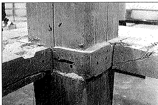
Fotografía 1. Imagen de la rotura por punzonamiento en el pilar central, obtenida tras la demolición de la losa.
