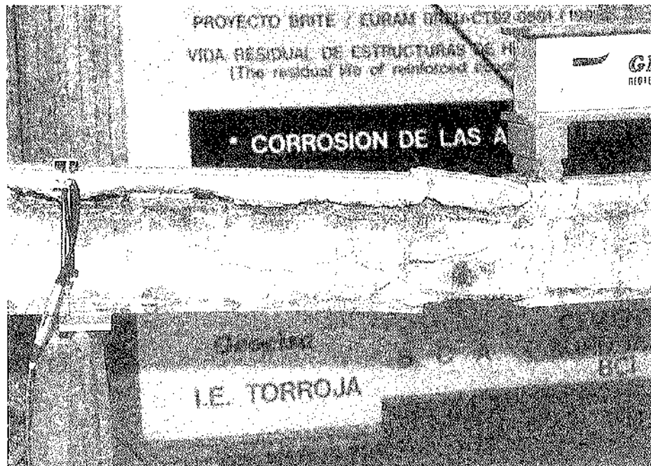
Figura 10. Rotura a cortante (tipo 3).
