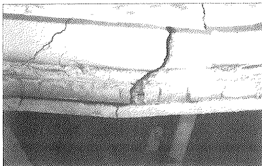
Forjado armado, con refuerzo superior-inferior. Rotura por agotamiento de la armadura de tracción.
