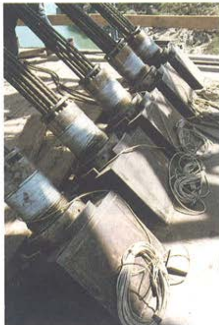
Figura 30. Anclaje de retenidas en el tablero. Figure 30. Anchorage for back cables at the deck.
