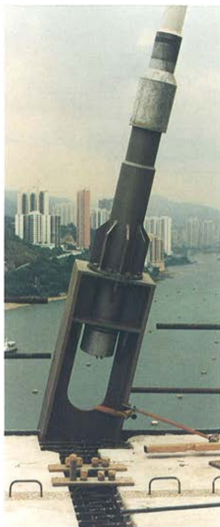
Figura 11. Anclajes de los cables en el tablero. Figure 11. Cable anchorages on the deck.
