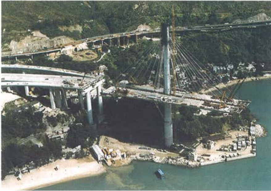
Figura 20. Mástil de Ting Kau. Construcción del tablero en voladizo. Figure 21. Ting Kau mast. Cantilever deck construction.
