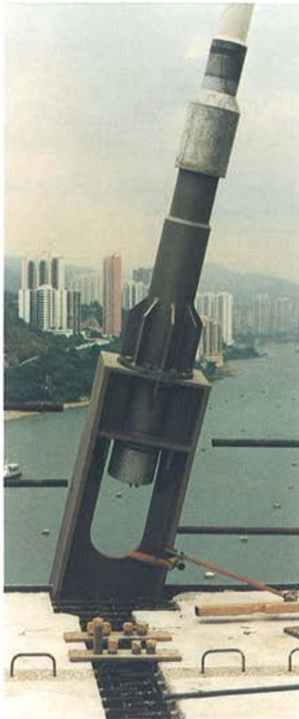
Figura 11. Anclajes de los cables en el tablero. Figure 11. Cable anchorages on the deck.
