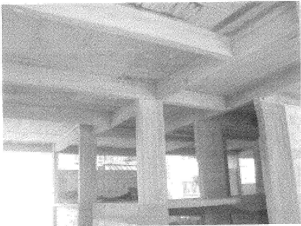
Foto 15. Mala configuración estructural de entramados que forman pórticos.
