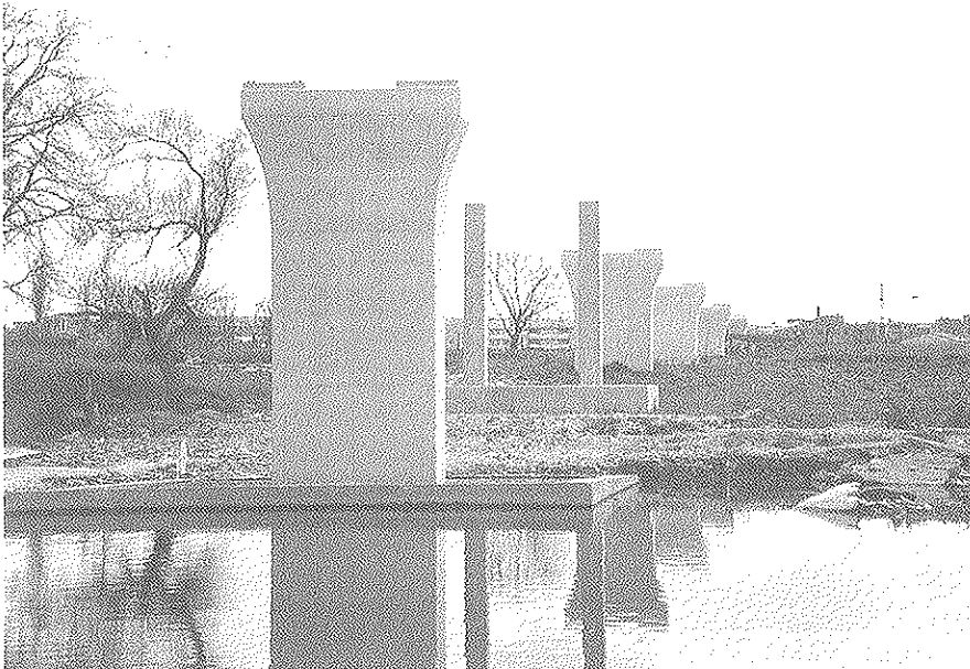
Figura 8. Vista general de pilas, con el apeo de montaje en el vano adyacente al río.
