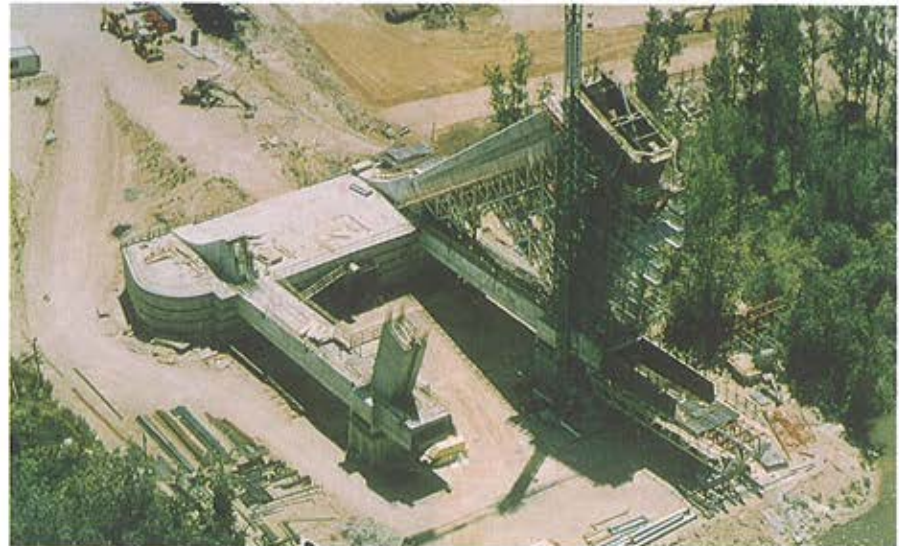
Foto 2. El contrapeso, y los arranques de las células laterales, con la de aguas abajo en fase avanzada de construcción ya que sólo se empleó un equipo de cimbra y carro de mástil. Figure 2. The counterweight and the beginning of the lateral cells. The downstream cell is more advanced than the upstream one, because only one equipment for centering was used.
