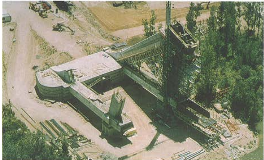
Foto 2. El contrapeso, y los arranques de las células laterales, con la de aguas abajo en fase avanzada de construcción ya que sólo se empleó un equipo de cimbra y carro de mástil.
