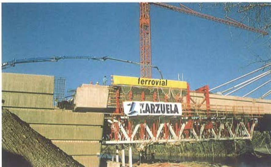
Figura 8. Llenado de la última dovela, que contacta con el diafragma de apoyo sobre el estribo de margen derecha. Figure 8. Erection of the last segment of girder, connecting with the transverse diaphragm placed over the abutment of the right bank.
