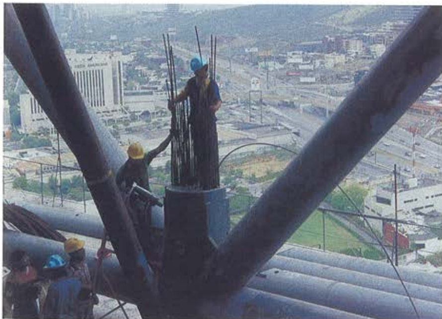
Figura 10. Tesado de un tirante, mediante gato unifamiliar Figure 10. Stressing a stay, using monostrand jack
