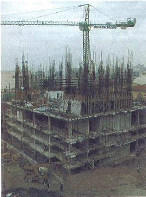
Estructura de base del edificio. Forjados para estacionamiento. Building basement structure. Parking floor slabs.
