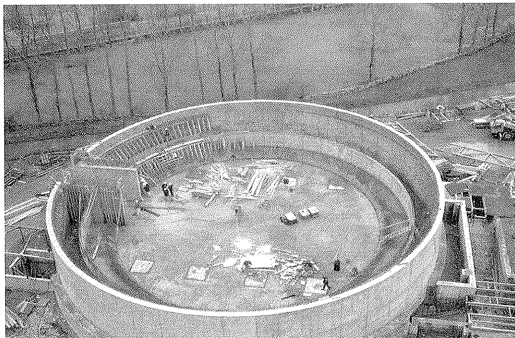
Figura 11. Estructura de base en construcción, en situación anterior al hormigonado de las paredes de forma troncocónica.
