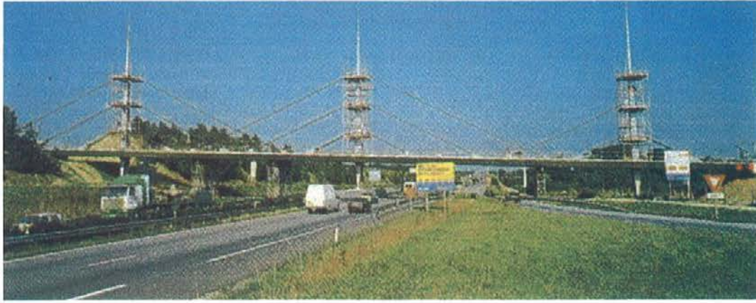
Figura 49. Vista del puente de Val de Rennes durante la construcción. Figure 49. View of the Val de Rennes bridge during construction.
