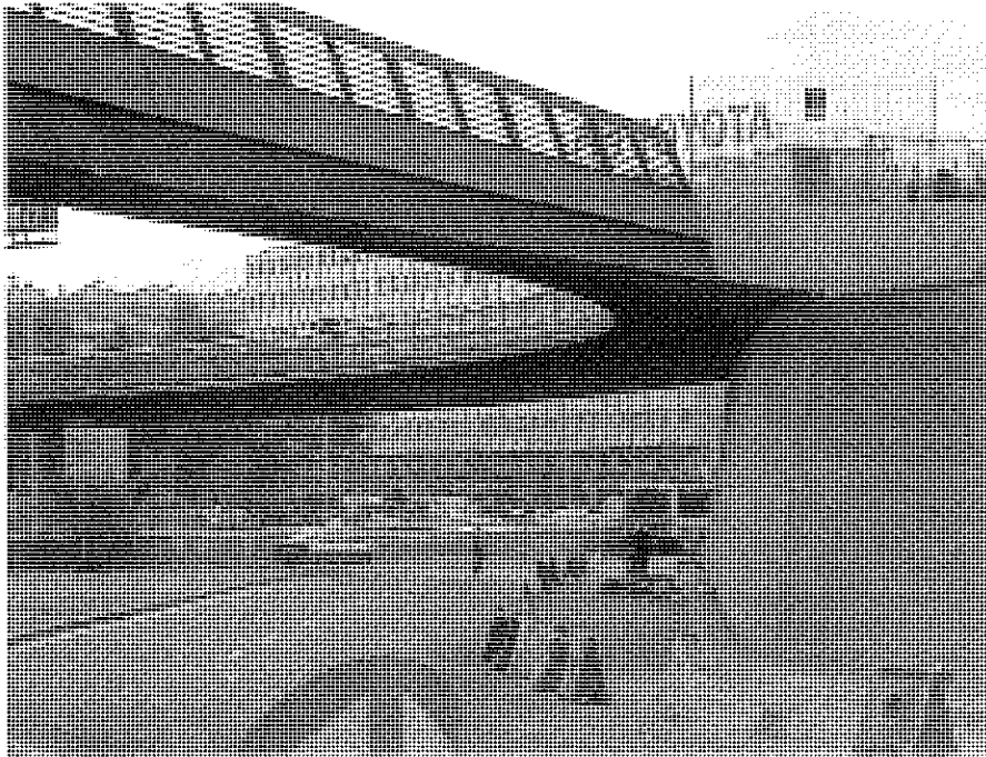
Fig. 7. Vista general de las pasarelas apoyadas en el voladizo mixto sobre el muro de hormigón. Se aprecia la continuidad de la cara inferior del voladizo y las pasarelas.
