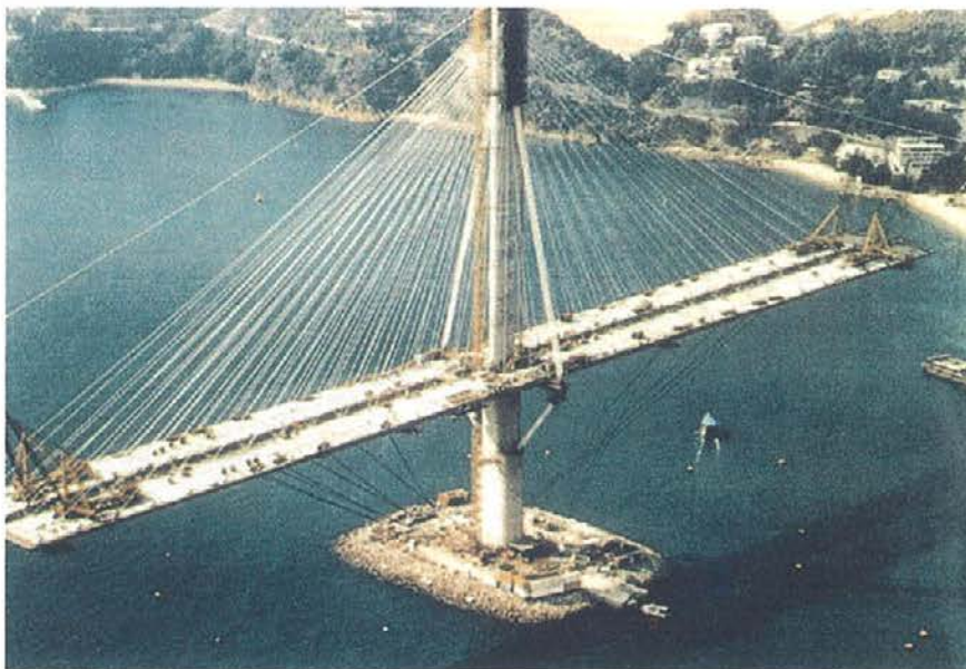
Figura 55. Detalle de la pila durante la construcción del puente de Ting Kau. Figure 55. Pylon detail during construction of Ting Kau bridge.
