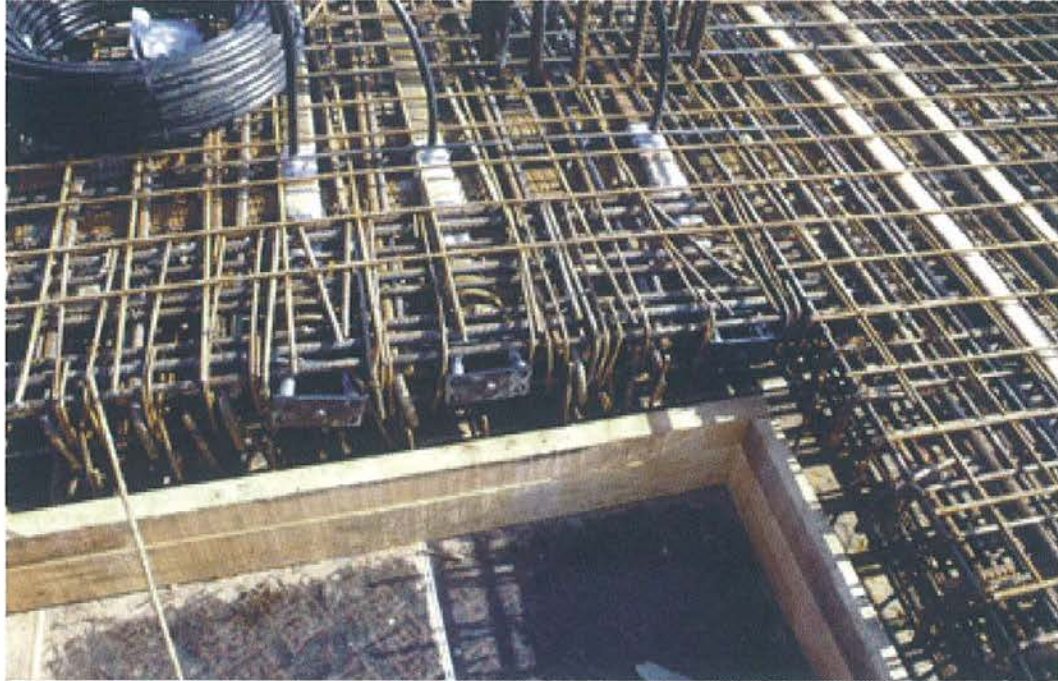
Figura 9. Foto de hueco cerca de pilar con cables de pretensado. Figure 9. Details of an opening of the slab.
