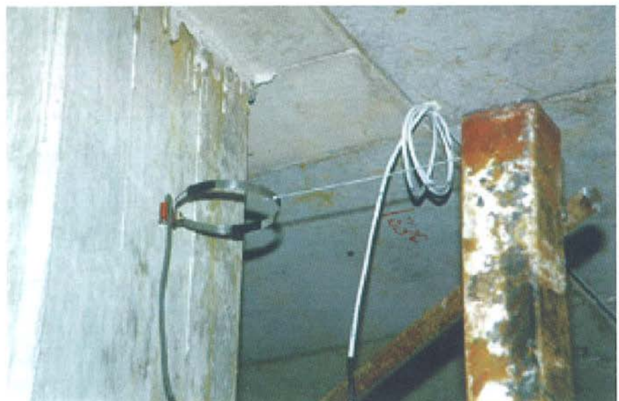
Figura 25. Sonda de temperatura en forjado. Figure 25. Measuring of temperatures into the slab.
