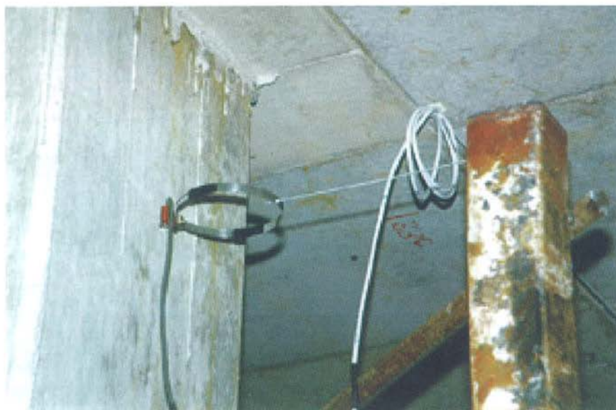
Figura 25. Sonda de temperatura en forjado. Figure 25. Measuring of temperatures into the slab.
