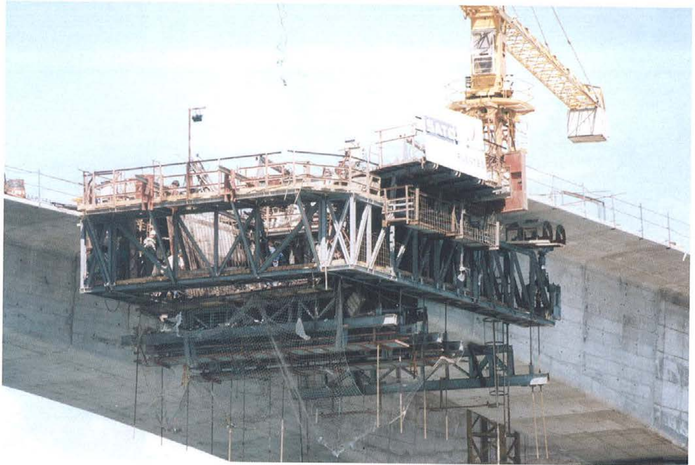
Foto 9. Detalle del carro de avance en voladizo. Photo 9. View of the carriage.
